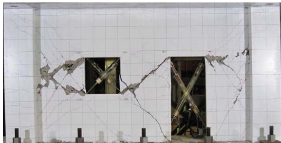
(c) 1/200rad. 加力終了時 (最大ひび割れ幅 →ピーク時 : 12.0mm、除荷時 : 11.0mm)
