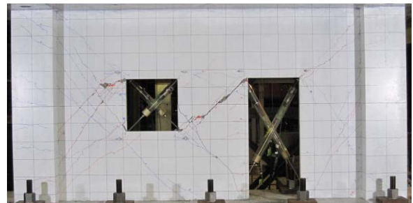
(b) 1/400rad. 加力終了時 (最大ひび割れ幅 →ピーク時 : 3.0mm、除荷時 : 2.7mm)
