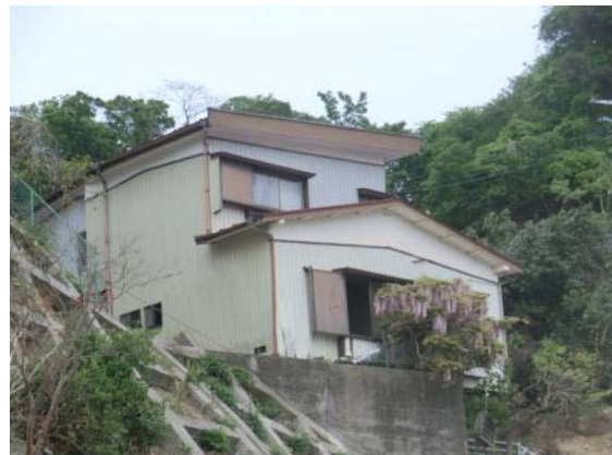
写真 C-13. 21 宮ヶ崎川尻の移動した住宅
