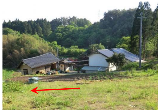
写真 C-7.28 写真 C-7.25 よりも山側に建つ木造住宅（左側の建物は津波により大破し、右の建物はサッシガラスの損傷）
