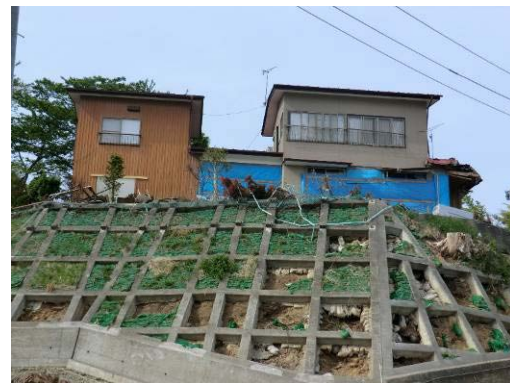
写真 C-13.15 城場地区の傾斜地に建つ木造住宅（1階天井まで浸水）
