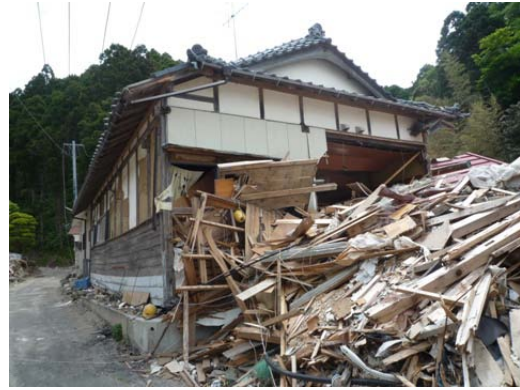
写真 C-20.12 入射方向の一部を損傷して残存する 木造家屋
