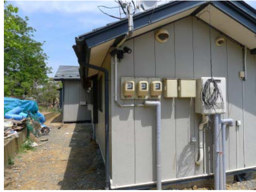
写真 C-8.6 残存した木造住宅
