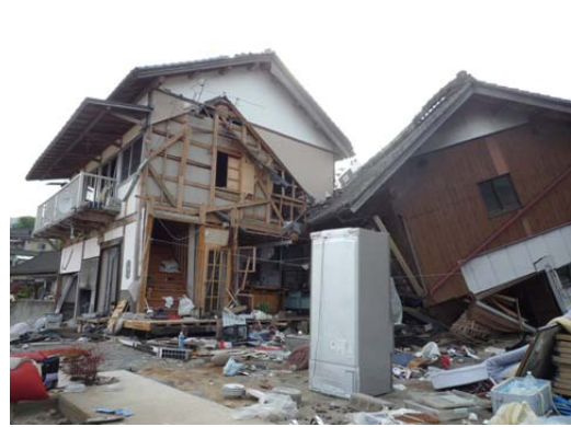
写真 C-12.12 倒壊した既存部分と増築部分との接続部分
