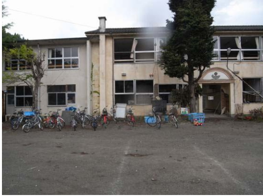
写真 C-3.1 赤浜小学校（右側が損傷した木造）
