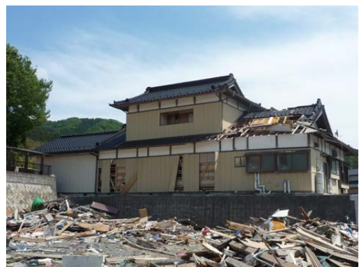
写真 C-10.8 赤碕町海岸付近で流失を免れた 木造家屋 (浸水深 6 m 以上)
