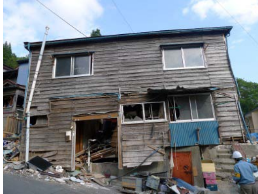
写真 C-4.12 基礎上端で大きく移動した木造住宅
