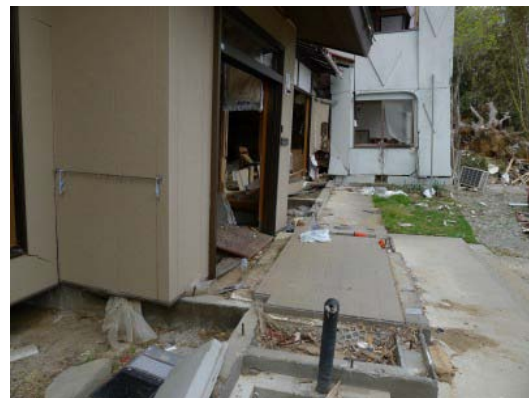
写真 C-16.4 移動した脚部
