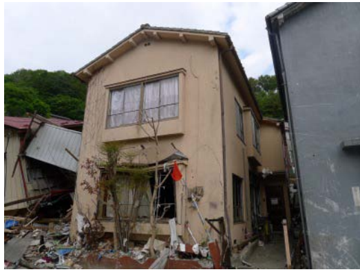
写真 C-4.2 土台と基礎がずれた木造住宅
