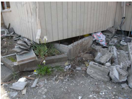
写真 C-9.3 浸水深測定建物の移動状況
