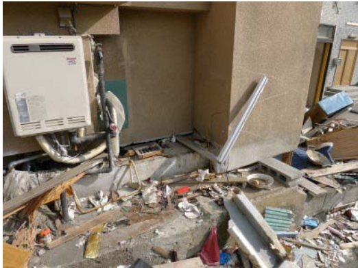
写真 C-4.11 前写真の基礎上端のずれ
