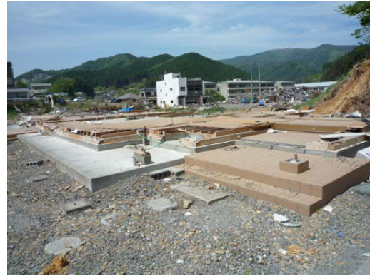
写真 C-10.10 流失した比較的新しい家屋の基礎、土台、床板（浸水深 6 m 以上）
