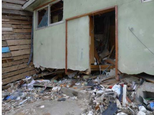
写真 C-4.6 前写真の 1F 柱脚部の状況
