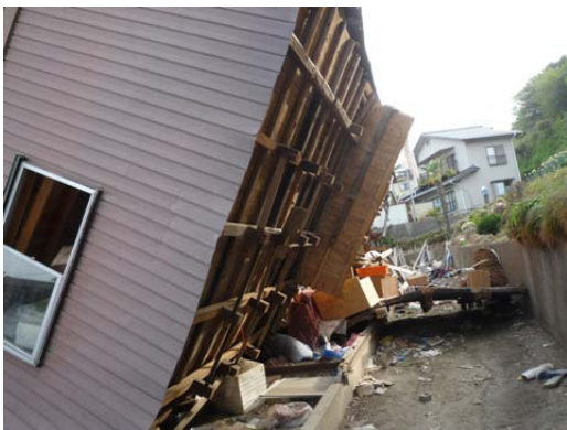
写真 C-12.7 転倒した家屋の脚部
