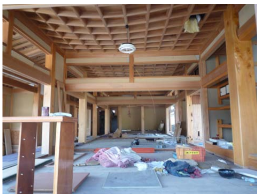
写真 C-10.7 写真 C-10.6 の内部 (浸水深 6~7 m)
