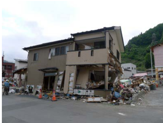
写真 C-4.4 大きく傾斜した木造住宅
