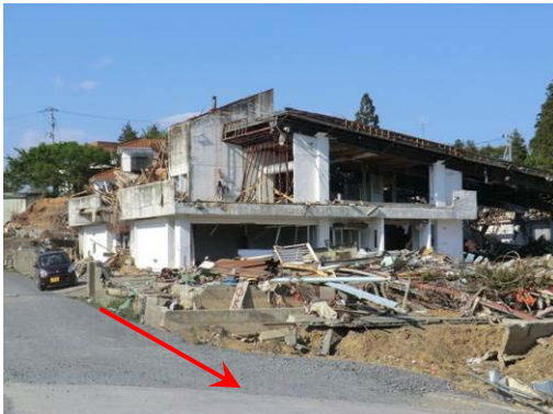
写真 C-7.25 津波による大きな被害を受けた RC 造の事務所建築物
