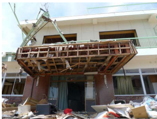
写真 C-8.2 庇がせん断変形した RC 造
