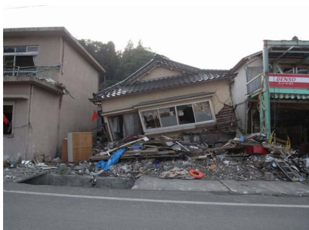
写真 C-5.3 層崩壊した木造住宅
