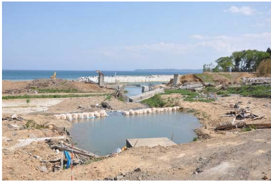
写真 C-7.18 津波が遡上した河口付近 (本吉町赤牛地区)
