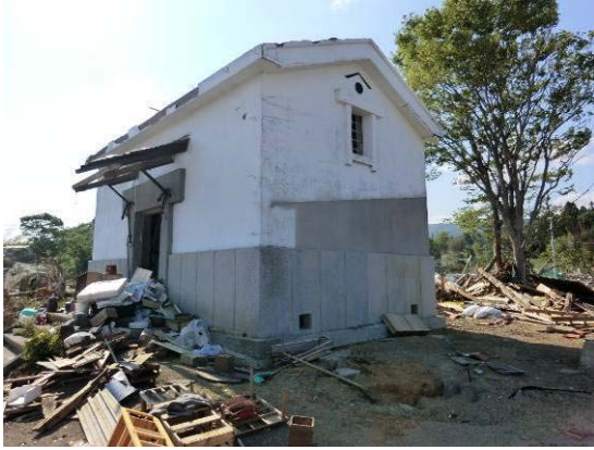
写真 C-7.22 残存するやや高台に建つ土蔵 (本吉町山谷・日門地区)
