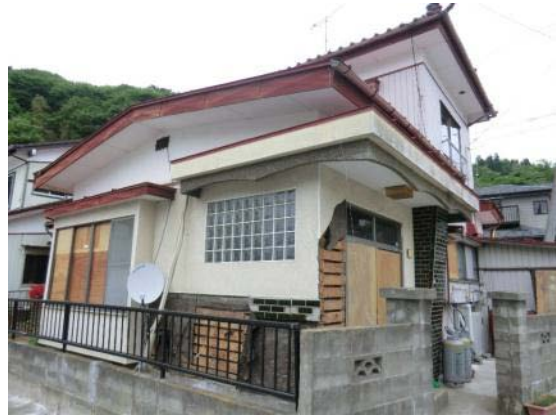
写真 C-13. 23 宮ヶ崎宮ヶ崎の津波による被害
