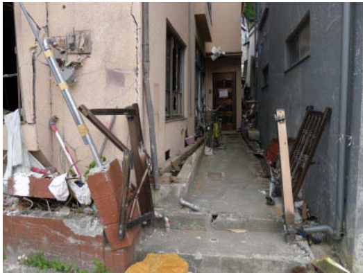
写真 C-4.3 前写真の建物のずれ
