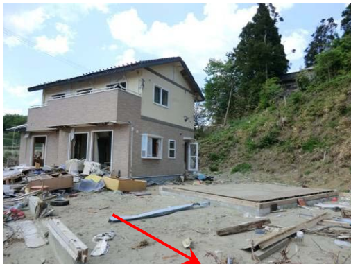
写真 C-7.14 M邸(奥)と流失した建物の基礎と床組部分(手前)
