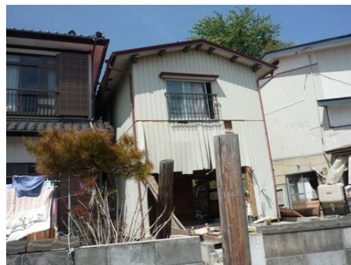
写真 C-10.2 写真 C-10.1 に隣接し、土台ごと移動した作業小屋
