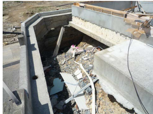
写真 C-10.12 写真 C-10.10 の北隅の洗掘孔
