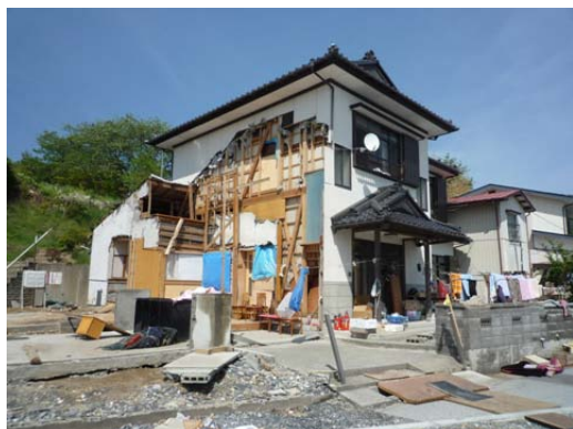
写真 C-10.1 赤崎町海岸付近で流失を免れた木造家屋(浸水深7m以上)
