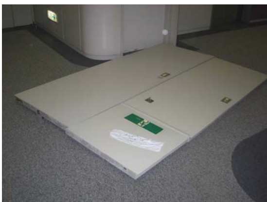
写真 7.4-2 枠から外れた防火戸 7-8)
