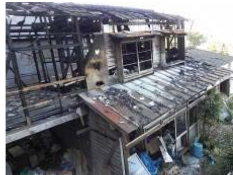
写真 7.2-8 出火した住宅
