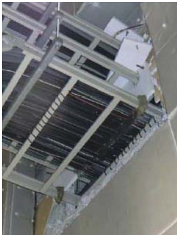
写真 7.4-1 防火区画貫通部の損傷 7-8)
