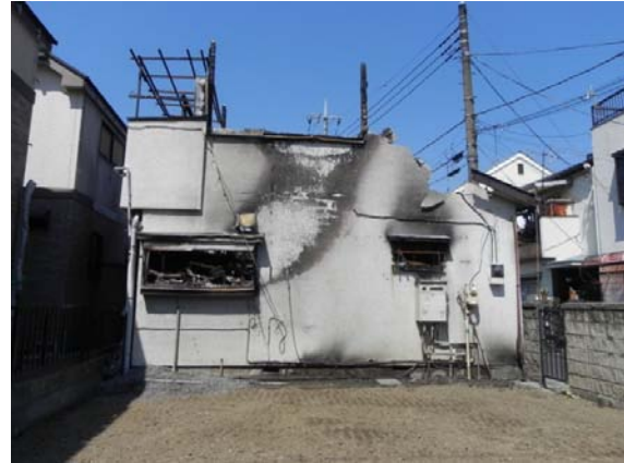
写真 7.2-23 火元建物外観(東側) 手前更地は類焼(全焼)した建物を撤去した跡地
