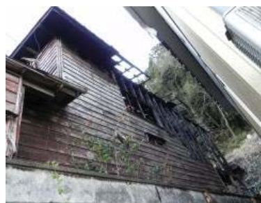
写真 7.2-10 出火した住宅
