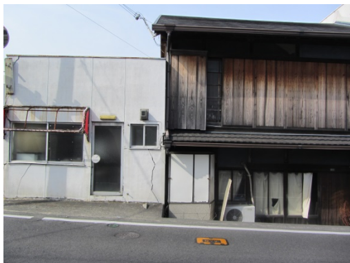
写真 5.10 モルタル仕上げのひび割れ
