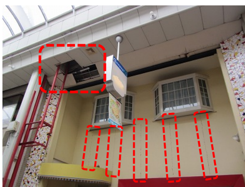
写真 5.1 壁のひび割れ、軒天井の損傷
