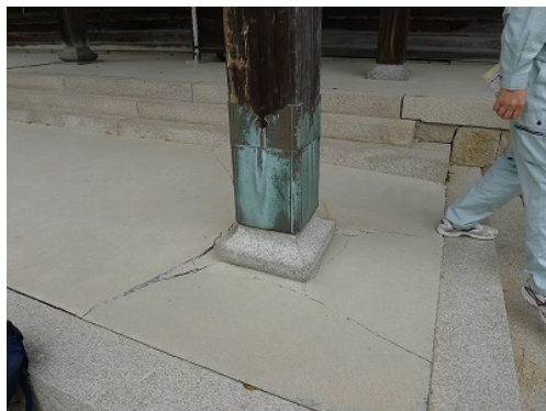
写真 6.33 亀裂の入った向拝下基壇部
