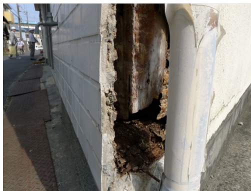
写真 5.11 仕上げ材の剥離 (柱脚に生物劣化の痕跡)
