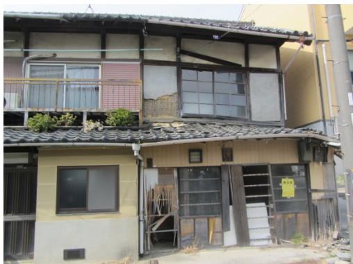
写真 5.12 傾いた木造住宅
