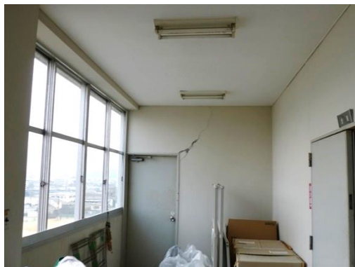
写真 5.28 同庁舎 5 階のひび割れ
