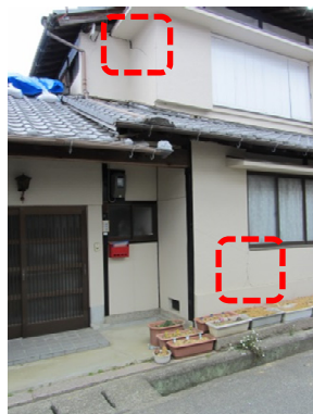
写真 6.28 屋根の被害と壁のひび割れ
