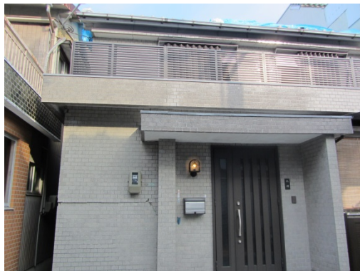
写真 5.26 タイル張り外壁の亀裂
