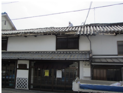
写真 5.2 屋根の被害(「要注意」の黄色紙)
