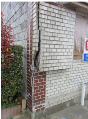
写真 6.11 仕上げタイルの損傷 (木骨 CB 造)
