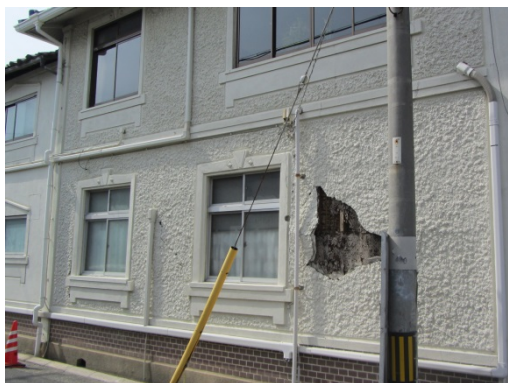
写真 5.3 ラスモルタル壁の損傷
