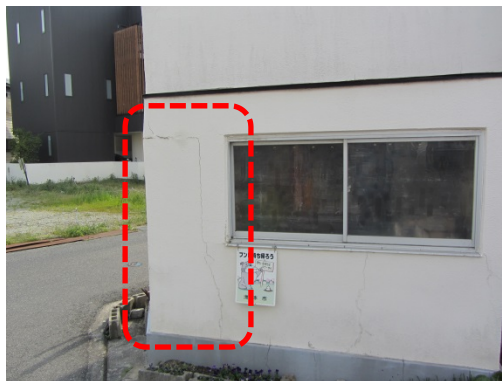
写真 5.13 仕上げのひび割れ
