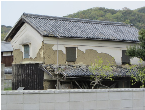
写真 6.30 土塗壁等の被害
