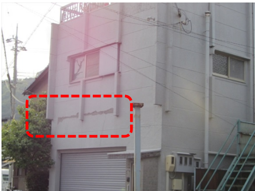
写真 5.25 ALC パネルのひび割れ
