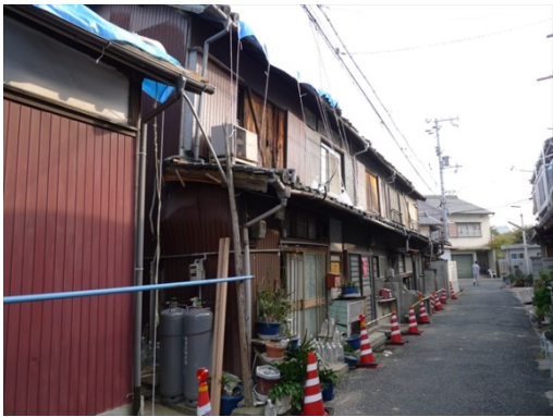
写真 5.23 傾斜した長屋（空き家が数軒）
