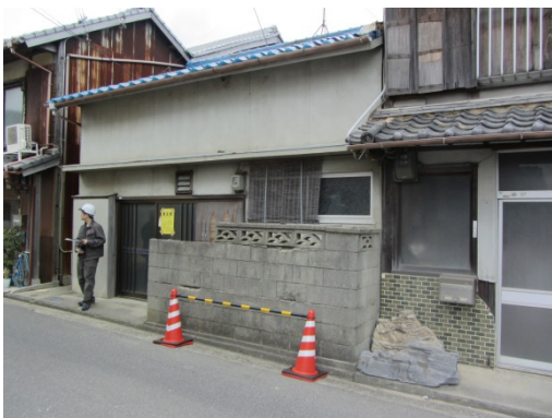
写真 6.9 ブロック塀の一部損傷
