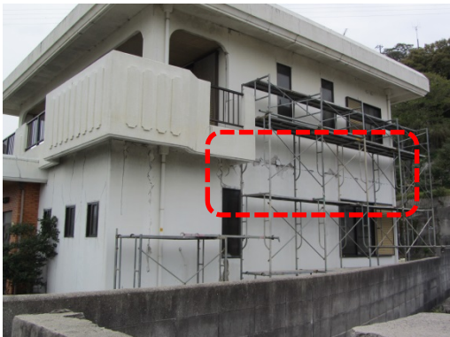
写真 6.24 ALC パネルの欠け
