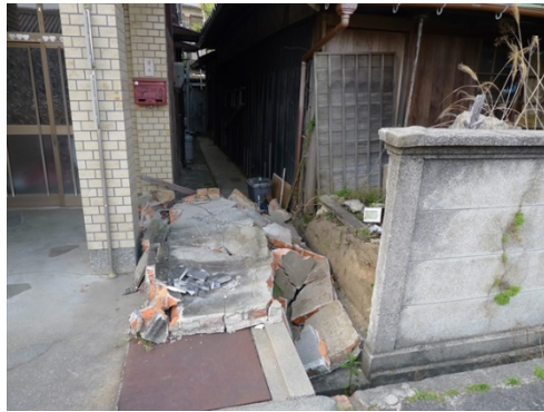
写真 5.24 ブロック塀の被害
