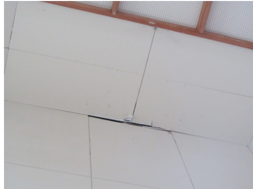
写真 6.6 同武道館 天井端部の損傷
