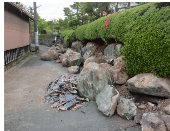
写真 5.5.13 石積み擁壁の被害
