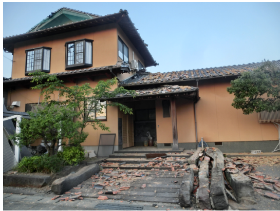
写真 5.5.9 土葺きの屋根瓦のみの被害
