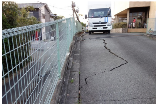
写真 5.4.4 敷地内の舗装のひび割れ
