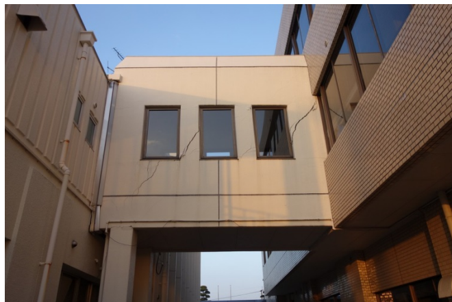
写真 5.4.5 渡り廊下の損傷
