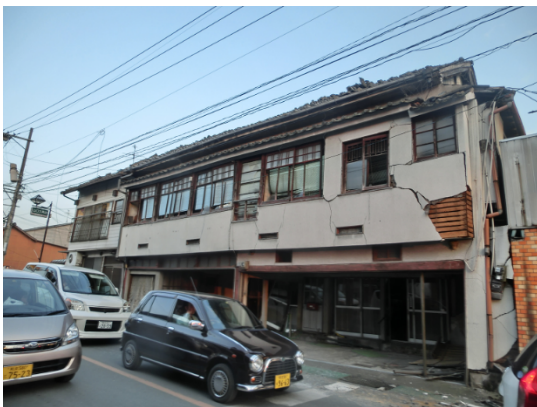
写真 5.5.6 軸組構法の店舗併用住宅の被害
