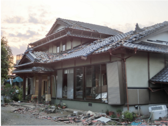
写真 5.5.8 比較的新しい伝統的構法の被害
