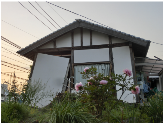
写真 5.5.4 壁が外れた家屋
