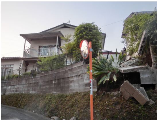
写真 5.5.12 増し積み擁壁の被害
