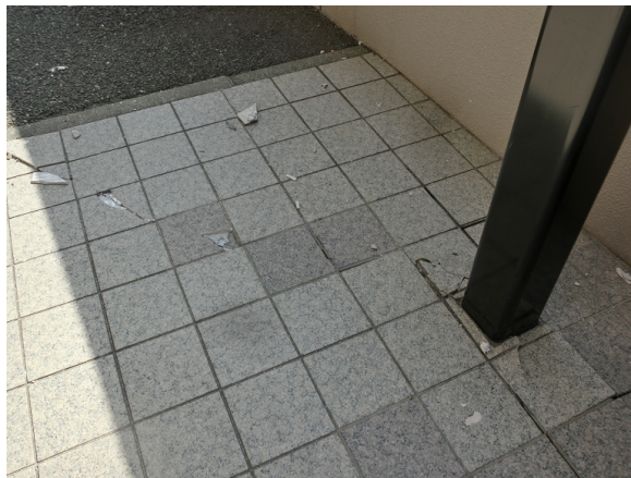
写真 5.2.3 入り口付近のタイルの割れ
