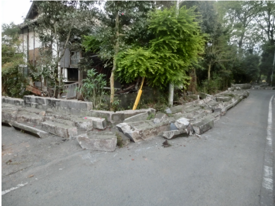
写真 5.5.14 組積造の塀の被害
