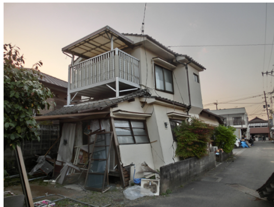
写真 5.5.5 残留変形が大きな家屋
