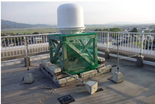
写真 5.4.3 屋上の設備の損傷（脚部）
