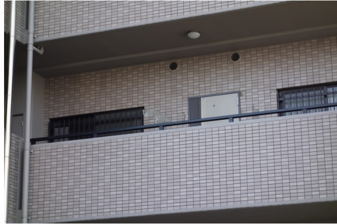
写真 5.2.2 渡り廊下部分と非構造壁の被害
