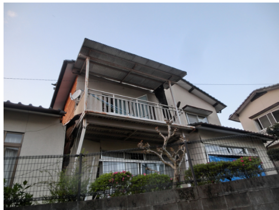
写真 5.5.15 写真 5.5.12 の擁壁に支えられ、 宅地変状により被害が甚大な家屋
