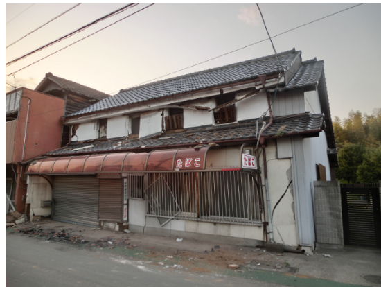
写真 5.5.7 土壁を有する伝統的な町屋の被害
