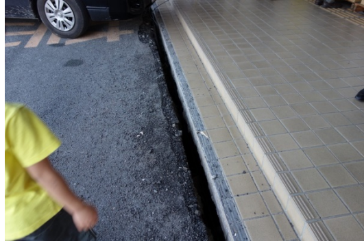
写真 5.4.2 玄関前の基礎版と周辺地盤の隙間
