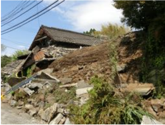
写真 5.3.1 地盤の影響により大破した家屋
