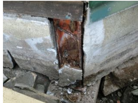
写真 5.2.12 写真 5.2.10 の建築物の一部に 使用された鋼材（木部が腐朽で喪失）
