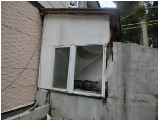
写真 5.1.10 宿泊棟北側の浴室の破壊
