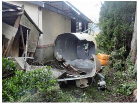
写真 5.1.14 貯水タンクの転倒・破壊
