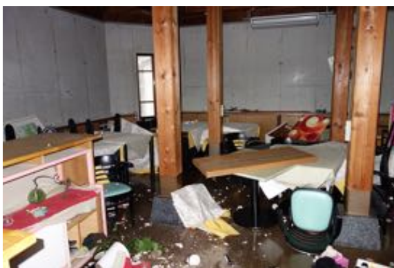
写真 5.1.4 RC 造食堂棟の内部の被害状況
