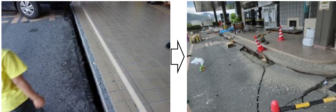
写真 6.1.2 玄関前の基礎版と周辺地盤の隙間（左：4/15、右：4/16）
