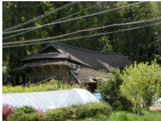
写真 5.3.2 大きく傾斜した建築物
