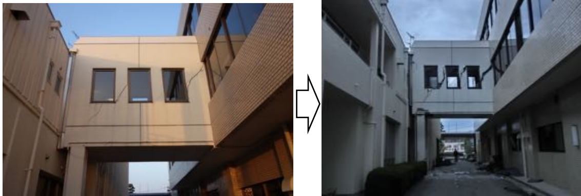
写真 6.1.4 渡り廊下の軽微な損傷（左：4/15）と大きなひび割れ（右：4/16）
