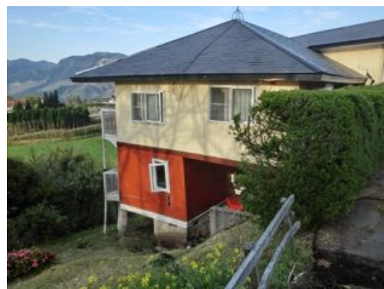
写真 5.2.16 1階の RC 支柱が傾斜した建築 物
