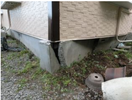
写真 5.1.7 宿泊棟の基礎の破壊
