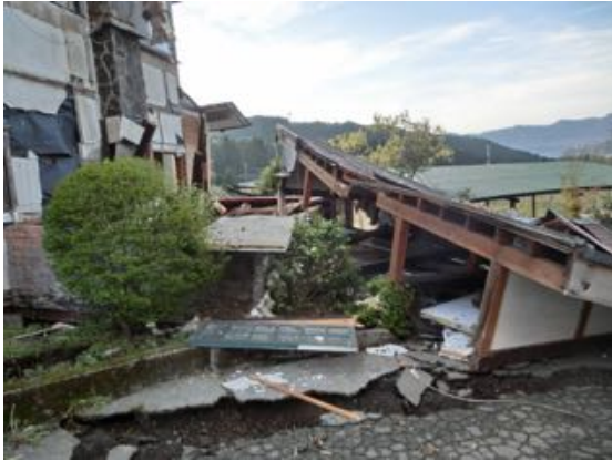
写真 5.2.13 下屋が崩壊した建築物
