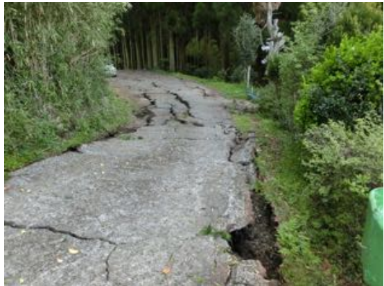
写真 5.2.4 エリア内の道路の亀裂
