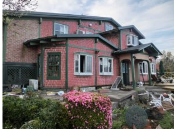
写真 5.2.10 崖下へ傾斜した木造宿泊施設
