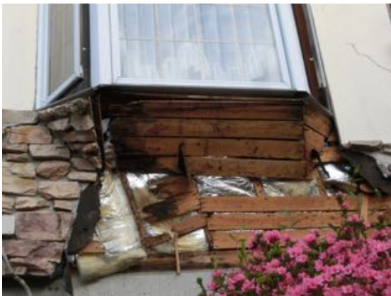
写真 5.2.15 写真 5.2.14 の建築物の出窓下の 外壁下地の腐朽
