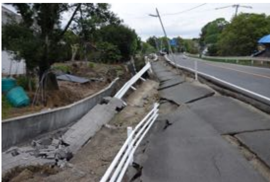
写真 5.7.3 破壊された路盤
