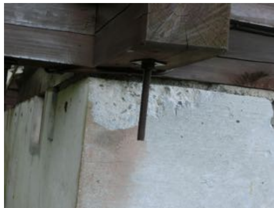
写真 5.1.20 ログハウスのコンクリート基礎の軽微な損傷
