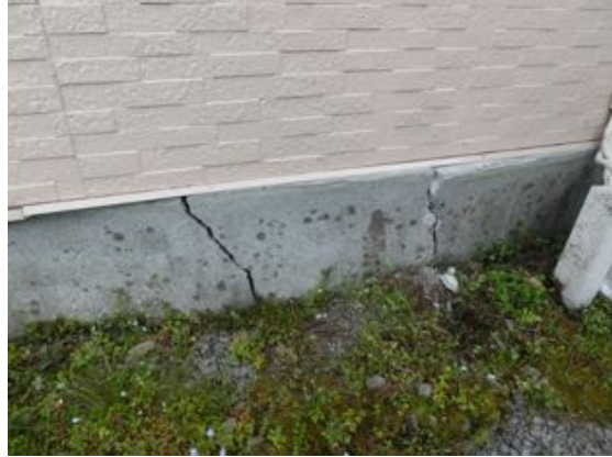
写真 5.1.6 宿泊棟の基礎の亀裂
