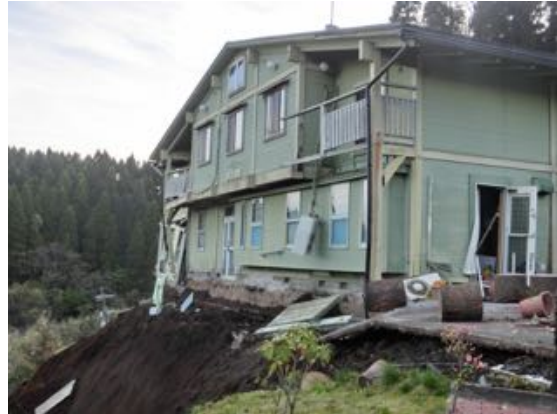
写真 5.2.8 敷地の西側が抉り取られた建築物
