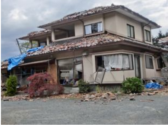
写真 5.5.3 被害が大きい最近の建築と思われる住宅
