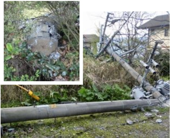
写真 5.2.6 エリア内の電柱の折損
