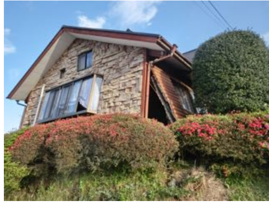
写真 5.2.14 壁が外れた建築物
