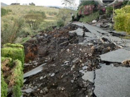
写真 5.2.1 アクセス道路の路盤崩壊
