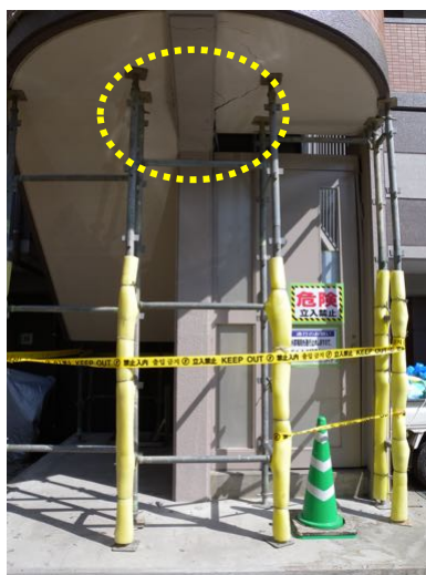
写真 5.8.3 外階段の被害
