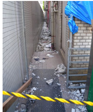
写真 5.2.6 隣接建物（右）の外装材落下被害
