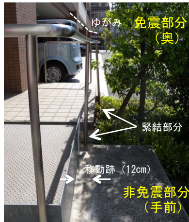
写真 5.9.4 エキスパンション部の変状 (手すりの変形、移動跡)
