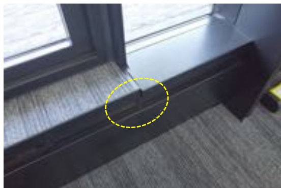
写真 5.2.4 窓サッシ部の金具のずれ
