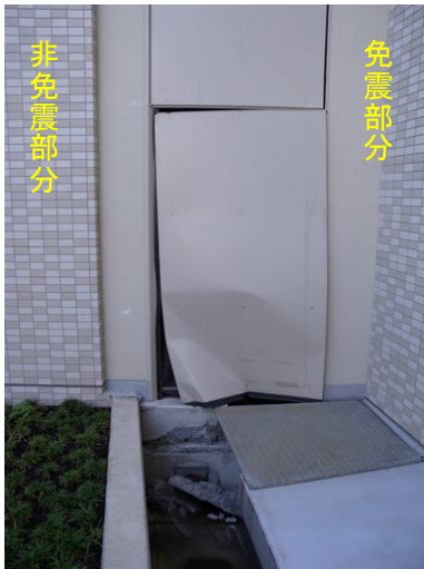
写真 5.1.3 エクスパンションカバー周囲の変状
