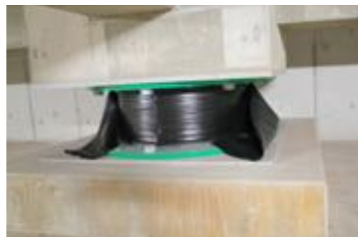
写真 5.3.2 積層ゴム被覆カバーの外れ
