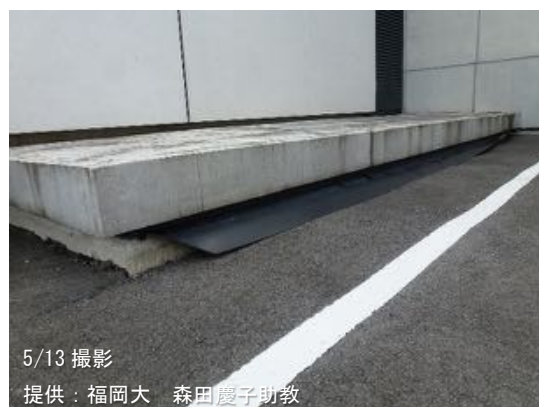
写真 5. 10. 2 免震スカートのはみ出し
