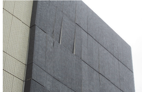
(h) 南面外壁 (拡大) PC パネルの面外への ずれ
