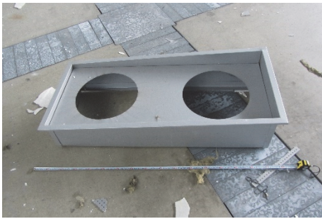
(c) 脱落した照明ボックス (b ホール)
