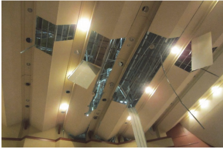
(g) 天井脱落部分見上げ
