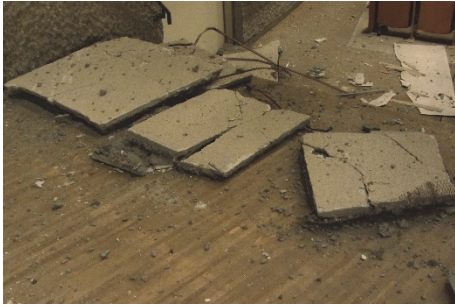
(i) 天井の立ち上げ部分の舞台への落下
