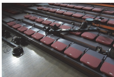
(c) 落下した照明
