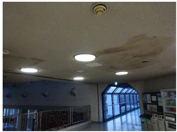
写真 3.9 天井の漏水痕
