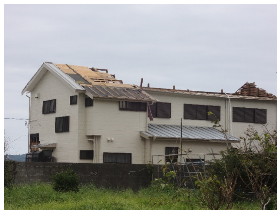
写真 4. 3. 24 木造住宅の小屋組の損壊(2)
