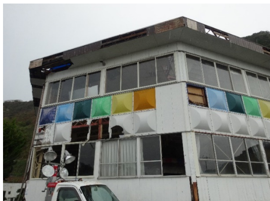
写真 4.2.15 公園施設Aの外壁・ 軒天井の被害状況
