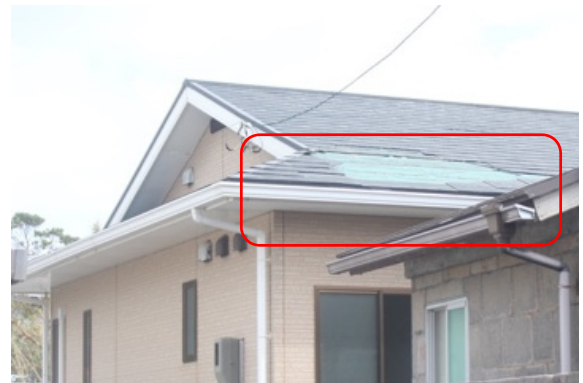
写真 5. 2. 13 住宅の屋根被害
