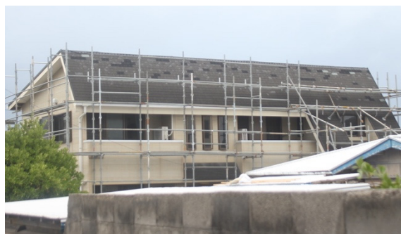
写真 5. 2. 14 住宅の屋根被害
