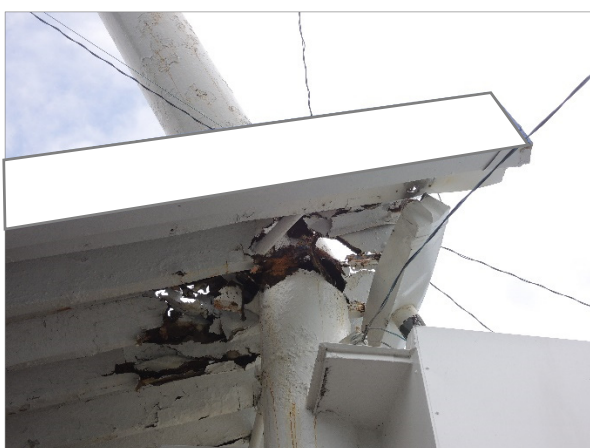
写真 4.3.21 キャノピーを支持する柱の折損(2)
