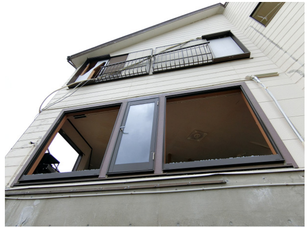
写真 4.3.68 海側の窓ガラスの破損と脱落したアルミ製バルコニーの設置部分
