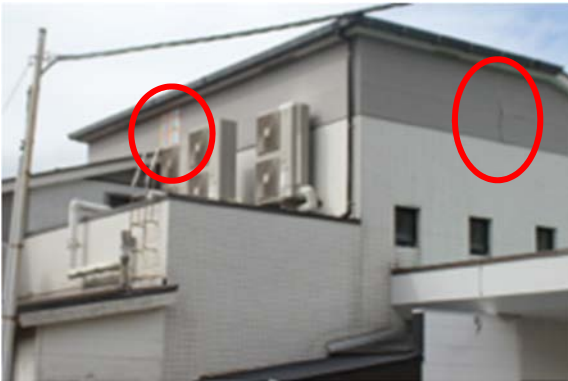
写真 5.1.42 RC 造の病院に増築された木造部分の外壁・軒の被害
