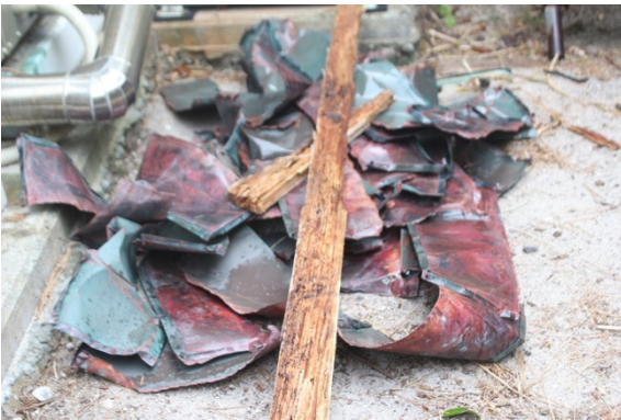
写真 5.1.56 脱落した屋根ふき材
