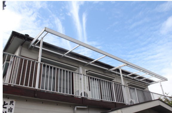
写真 5.1.43 住宅の庇の被害
