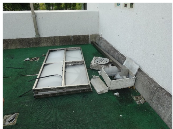
写真 3.13 屋外喫煙所のパーティションの倒壊
