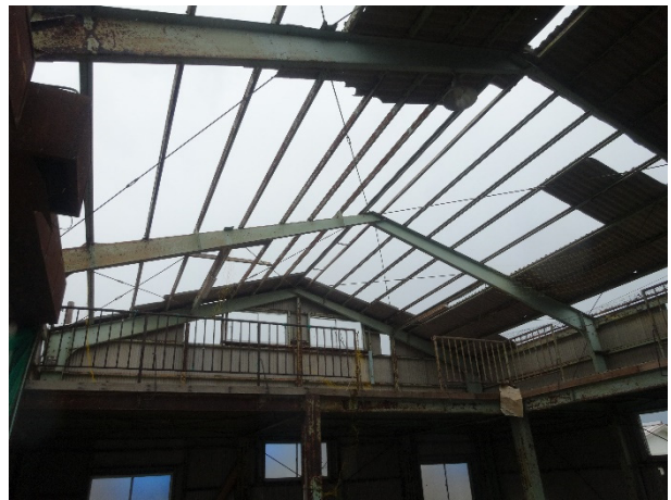
写真 4.2.28 屋根・窓ガラスの被害
