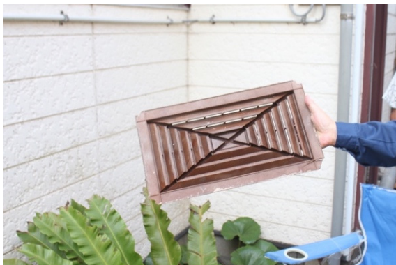
写真 5.1.49 落下した通気口
