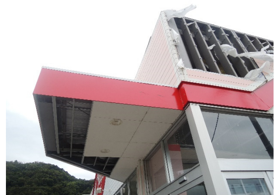
写真 4.1.4 軒天井の仕上げ材と隅角部での外壁材の脱落・飛散
