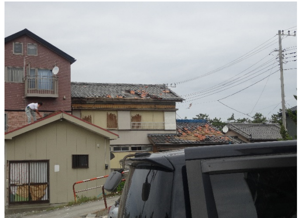
写真 4.3.8 隣接する住宅での瓦の被害
