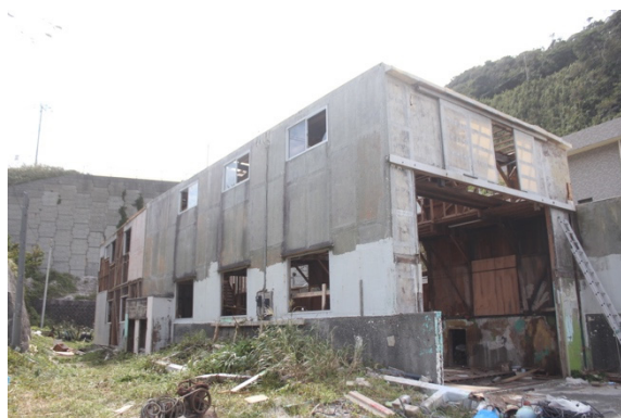
写真 5. 1. 10 木造の元造船所 B の被害
