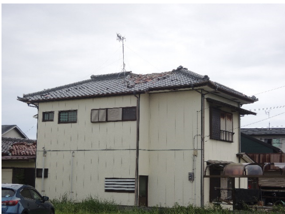
写真 4.2.11 木造住宅の棟瓦の脱落
