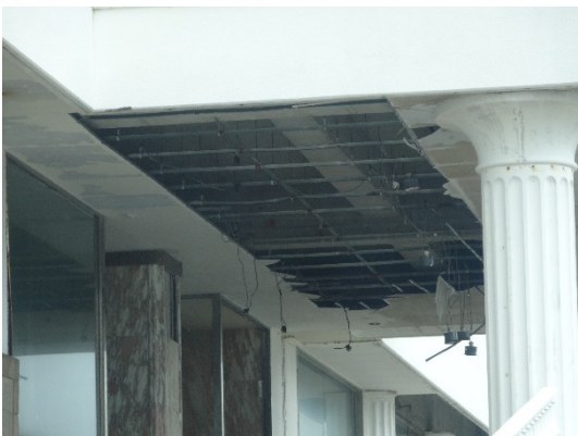
写真 4. 2. 23 エントランスの軒天井の被害
