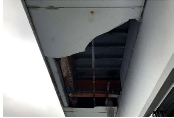
写真 5.1.30 宿泊施設 A の軒天井部材の破損
