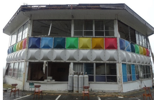
写真 4.2.16 公園施設Aのサッシ・ 窓ガラスの被害状況
