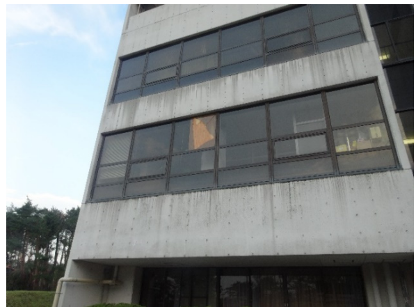
写真 3.7 第2庁舎西面でのガラスの破損
