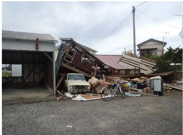
写真 4.2.12 老朽化した倉庫の倒壊
