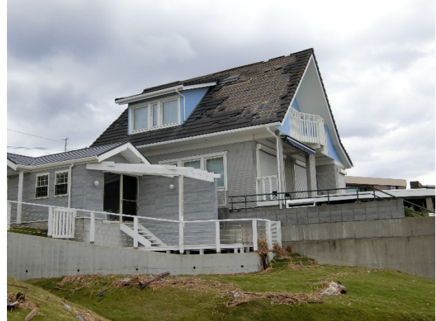
写真 4.3.73 屋根ふき材の脱落
