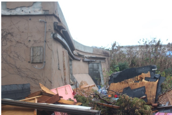
写真 5. 2. 22 倒壊した倉庫 B
