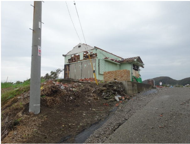
写真 4. 2. 32 屋根と外壁の被害
