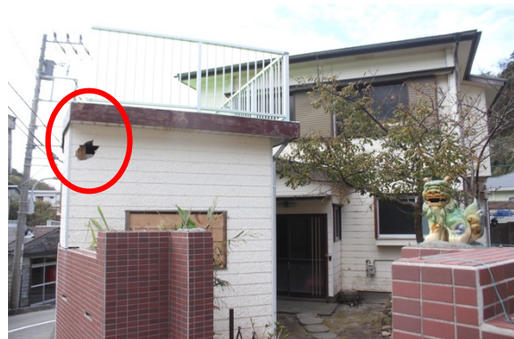
写真 5.1.48 飛来物による東面の壁の破損
