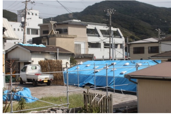
写真 5.1.41 住宅の屋根の被害
