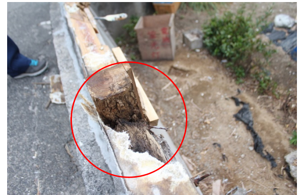
写真 5.1.28 ゴミ捨て場の土台の腐朽・蟻害
