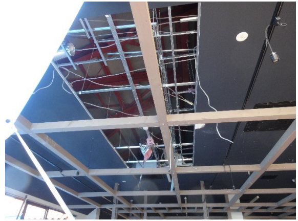
写真 4.2.4 屋内の天井仕上げ材の被害
