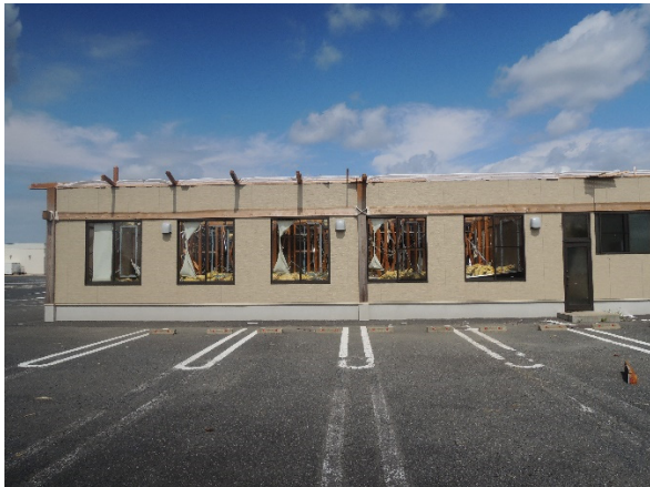
写真 4.2.5 小屋組が飛散した店舗 F の外観
