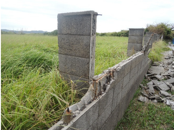
写真 4. 3. 25 ブロック塀の倒壊
