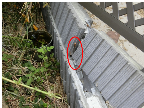
写真 4. 3. 28 ブロック塀の破壊部分から見える鉄筋
