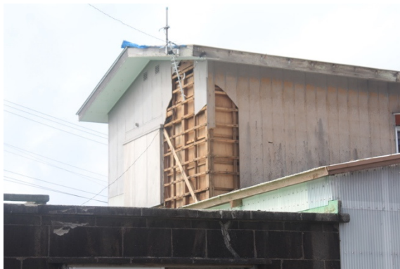
写真 5. 2. 12 店舗兼住宅の外壁被害
