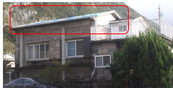
写真 5.2.35 住宅の屋根被害(2)
