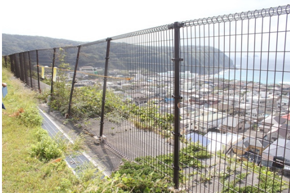
写真 5.1.7 フェンスの被害
