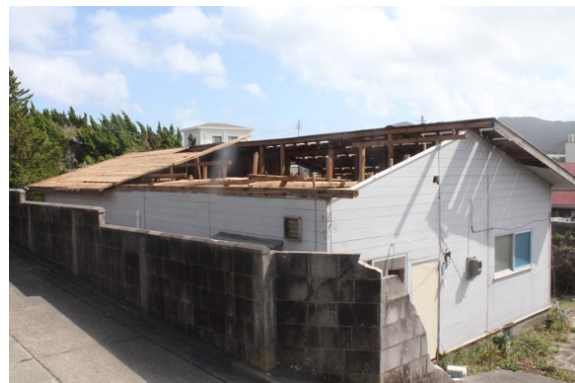
写真 5.2.9 住宅の屋根被害
