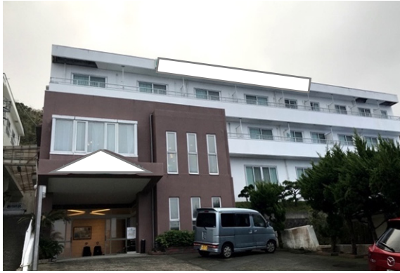
写真 5.1.29 軒下に被害を受けた宿泊施設 A
