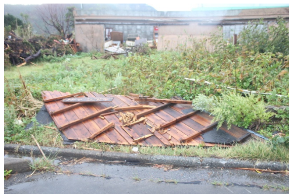
写真 5. 2. 27 飛散した屋根材
