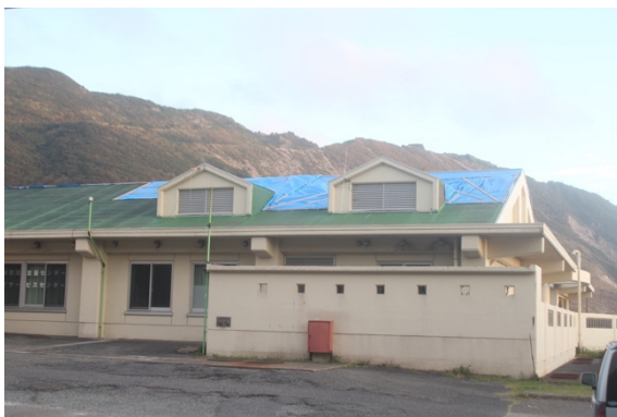
写真 5.2.39 介護施設の屋根被害 （建物南東面）
