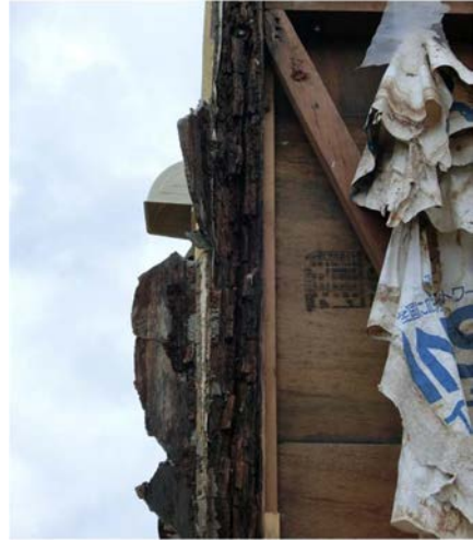
写真 4.3.62 写真 4.3.61 右側の躯体の生物劣化
