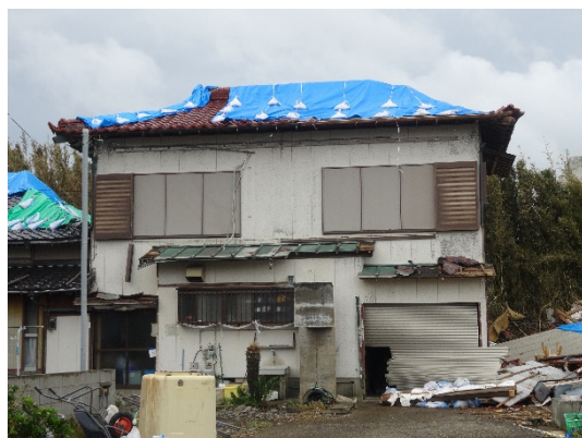
写真 4. 2. 36 倒壊した倉庫の隣の住宅
