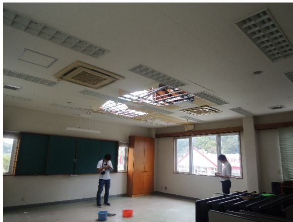
写真 4.1.17 2階天井の被害状況
