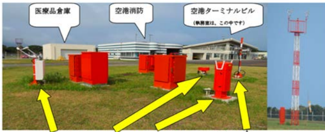
左から、視程計（視距離）、雨量計、シーロメータ（雲高・雲量）、温度計・湿度計 右の写真は、風向風速計（滑走路の両端に設置）
