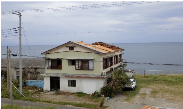
写真 4. 3. 41 屋根が飛散した海沿いの木造住宅
