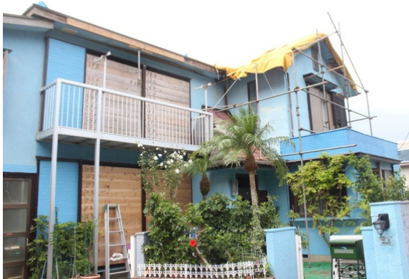
写真 5.1.19 住宅の屋根の被害 (開口部には防御板が嵌められている)
