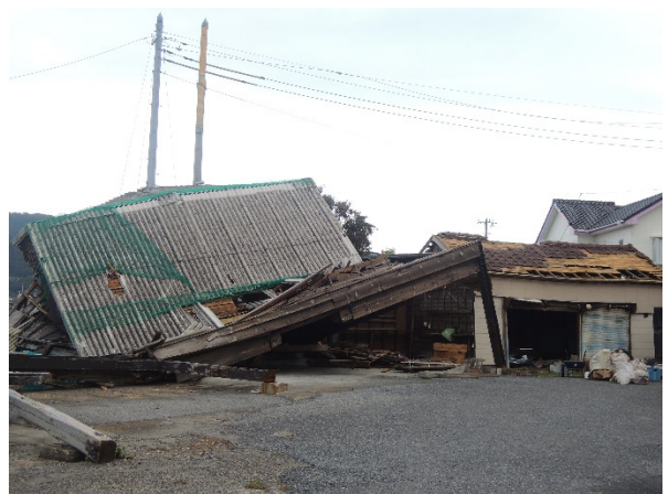
写真 4.1.25 鉄骨造倉庫の倒壊
