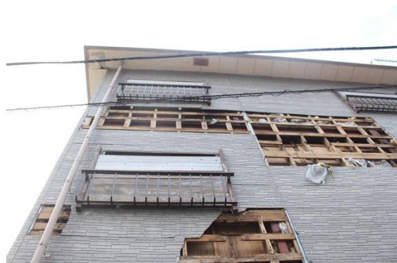
写真 5. 1. 54 外壁材の脱落
