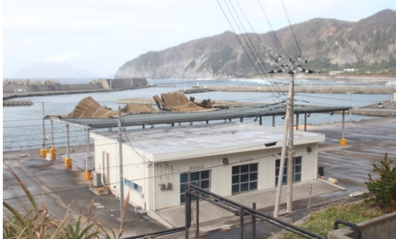
写真 5.2.30 漁港施設 A の屋根被害
