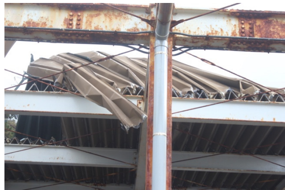
写真 5.2.33 風で捲れた屋根材
