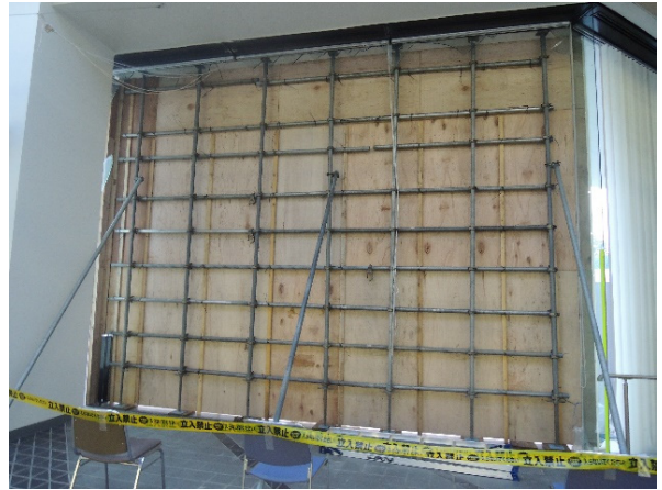
写真 3.3 第2庁舎南面入り口付近で破損したガラスの応急復旧状況(室内側)
