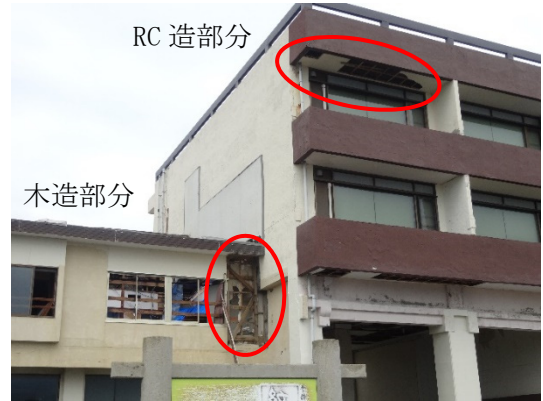
写真 4. 2. 20 外壁と軒天井の被害状況
