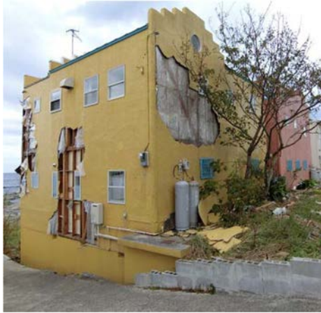
写真 4.3.63 写真 4.3.61 右側の住宅の被害状況
