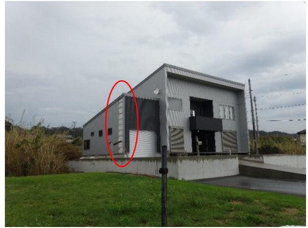
写真 4. 2. 31 住宅の隅角部での被害状況(2)
