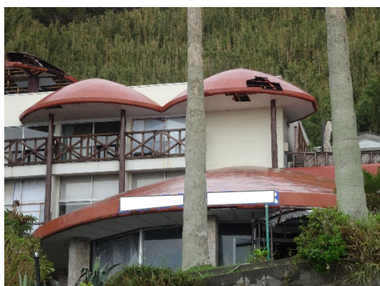
写真 4.2.17 宿泊施設Aの屋根・ 軒天井の被害状況
