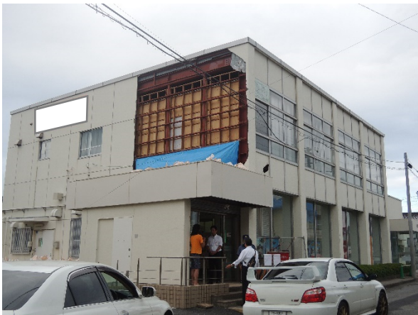
写真 4.1.7 店舗 C の外壁の被害状況
