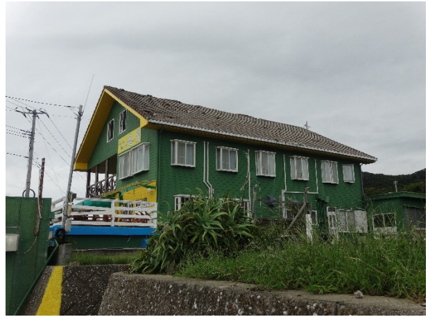
写真 4.2.26 屋根瓦の被害(風下側)
