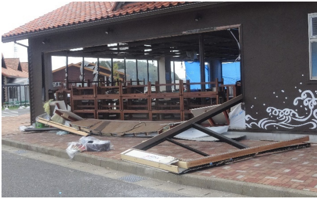
写真 4.2.3 屋外に面する建具の損壊と腰壁の転倒
