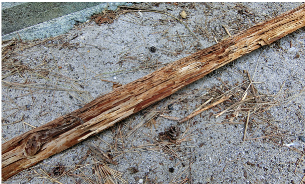
写真 5.1.58 受け材の蟻害
