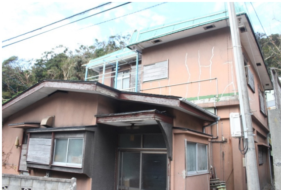
写真 5.1.47 南面の通気口の脱落
