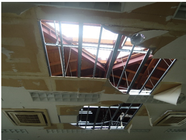
写真 4.1.18 2階天井と野地の被害状況
