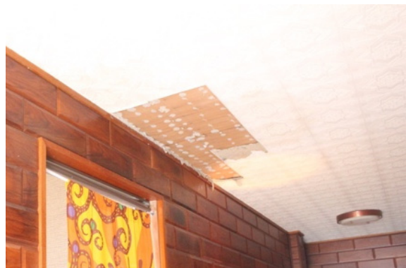
写真 5.1.50 雨漏りの被害
