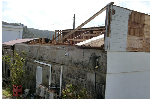
写真 5. 2. 11 店舗 C の屋根の被害
