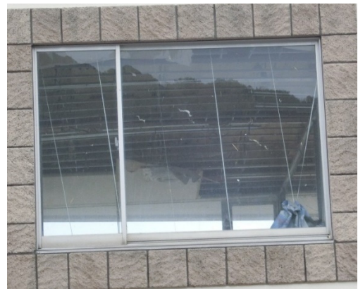
写真 4.3.70 窓越しに見える天井仕上げ材の脱落
