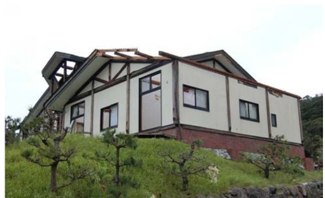
写真 4. 3. 53 連続する宿泊室部分の屋根の飛散
