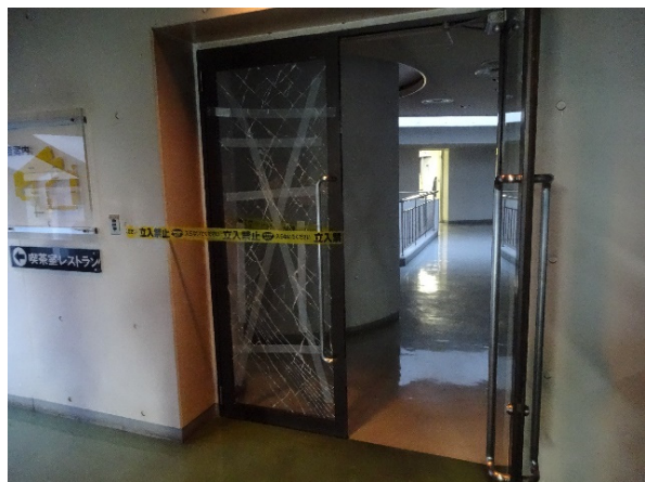
写真 3.10 議会棟入り口の扉の損傷
