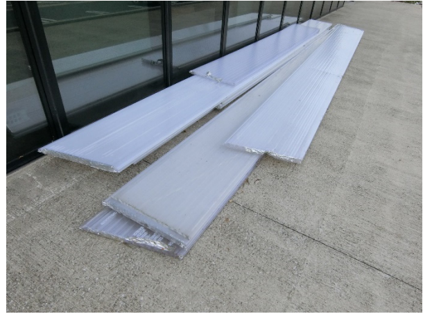
写真4.1.12 脱落した外壁材
