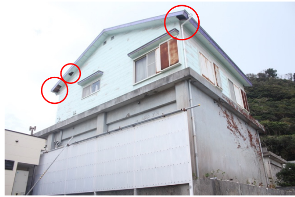
写真 5. 2. 17 住宅の軒被害
