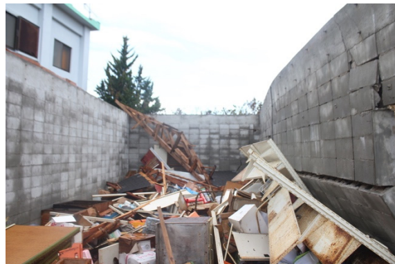
写真 5. 2. 23 倒壊した倉庫 B の内部
