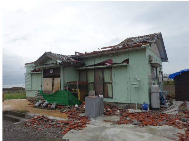
写真 4. 2. 33 屋根の被害状況
