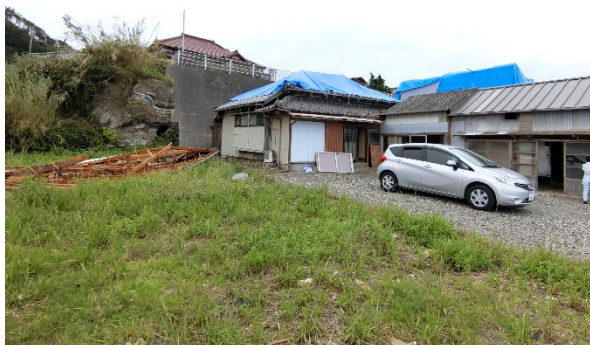
写真 4. 3. 43 北西へ吹き飛んだ木造住宅の屋根
