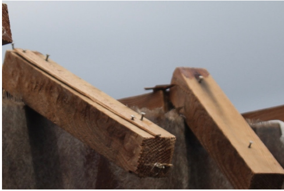
写真 5. 1. 14 屋根材を留め付けていた釘
