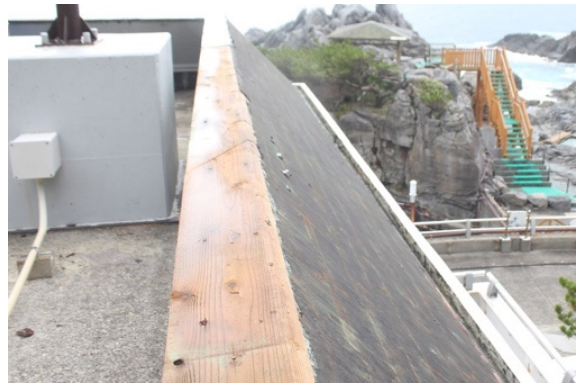
写真 5.1.57 屋根ふき材の飛散によって 露出した下地材
