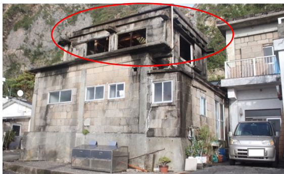
写真 5.2.34 住宅の屋根被害(1)
