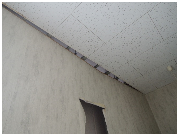
写真 4.1.19 階段室の壁材の変形
