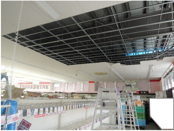
写真 4.1.5 店舗内部の天井仕上げ材の被害
