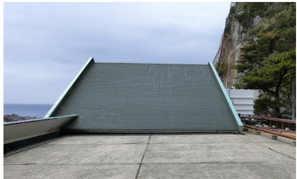
写真 5.1.59 既にアスファルトシングルへの 葺き替えが終わっていた三角屋根部分
