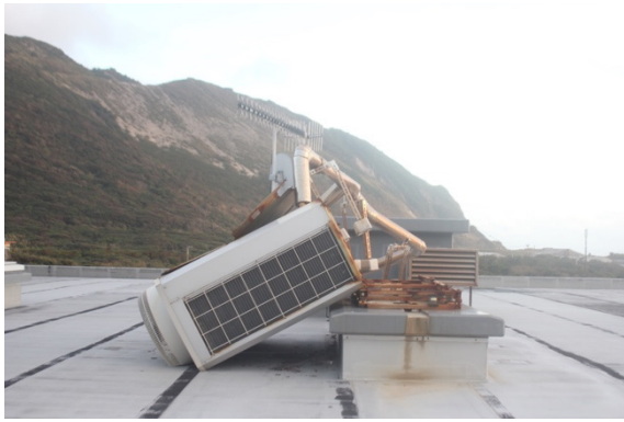
写真 5. 2. 41 西から東に転倒した 介護施設の室外機
