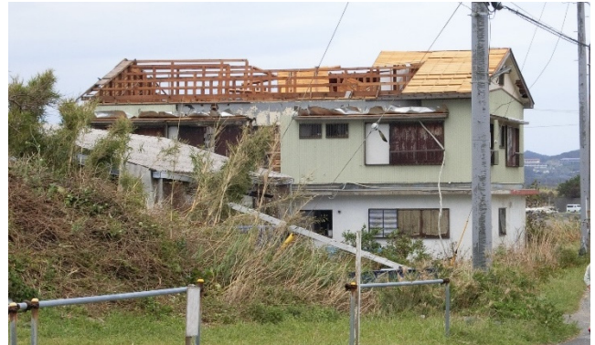
写真 4. 3. 42 小屋組の損傷状況
