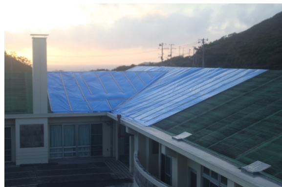
写真 5.2.40 介護施設の屋根被害 （写真 5.2.39 を東側から見た様子）
