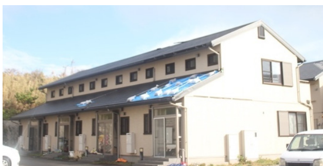
写真 5. 2. 28 共同住宅の屋根と軒の被害
