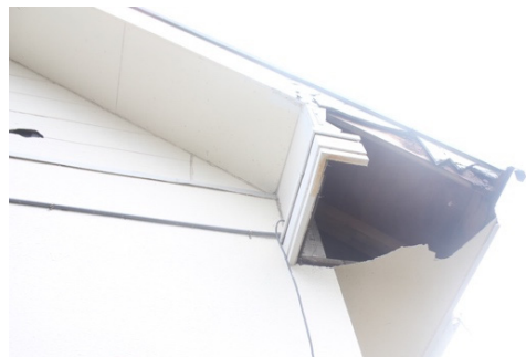
写真 5. 2. 29 写真 5. 2. 28 の住宅の軒天井の被害
