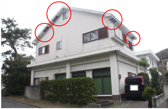
写真 5. 2. 16 住宅の軒被害
