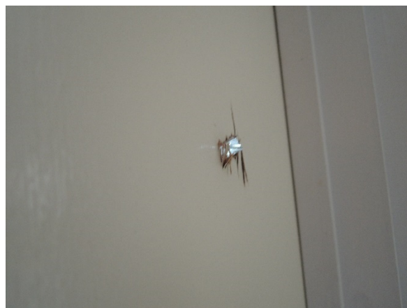
写真 4.1.21 窓ガラス破片のドアへの貫通 (廊下側から見る)
