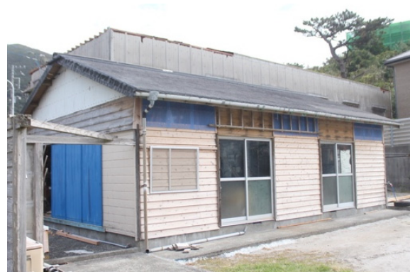
写真 5.1.20 住宅の屋根と壁の破損
