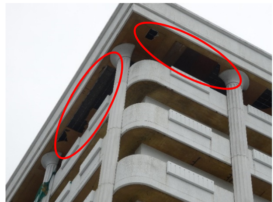
写真 4. 2. 24 最上階の軒天井の被害
