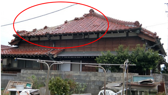
写真 4.3.31 寄棟における隅棟部の瓦の落下
