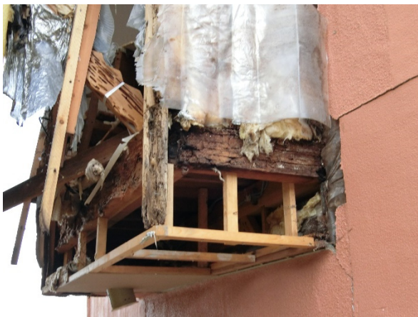
写真 4.3.65 躯体に生じた著しい腐朽・蟻害
