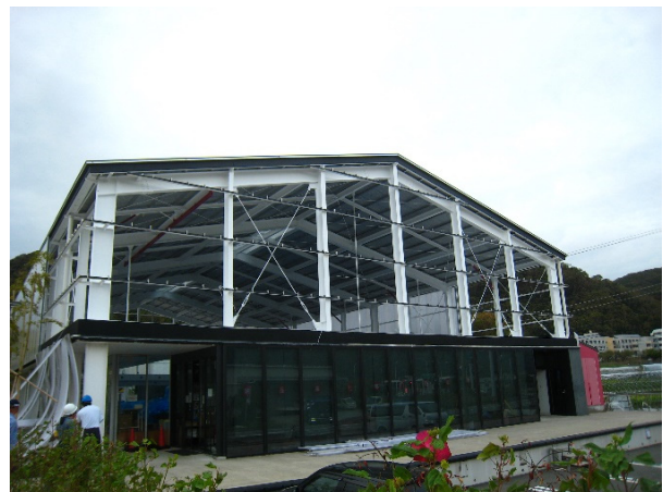
写真4.1.14 全ての外壁材が飛散した妻面
