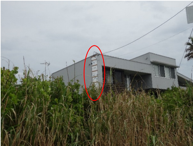
写真 4. 2. 30 住宅の隅角部での被害状況(1)
