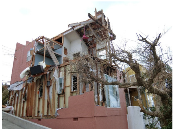
写真 4.3.64 写真 4.3.61 左側の住宅の外壁の崩落
