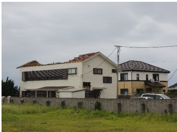
写真 4. 3. 23 木造住宅の小屋組の損壊(1)
