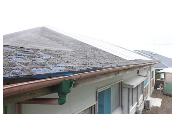
写真 5. 1. 52 屋根ふき材の被害
