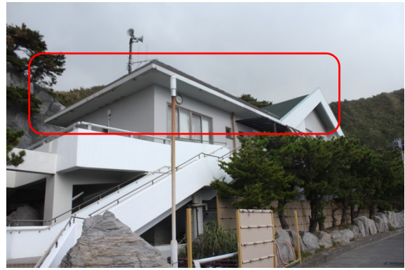
写真 5.1.55 温泉施設の屋根被害
