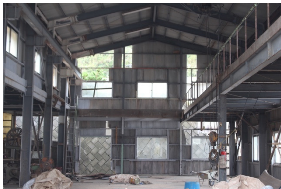
写真 5. 1. 9 鉄骨造の元造船所 A の被害 (内部)
