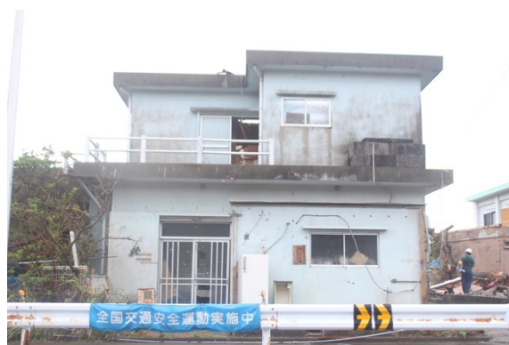
写真 5. 2. 25 住宅の屋根被害
