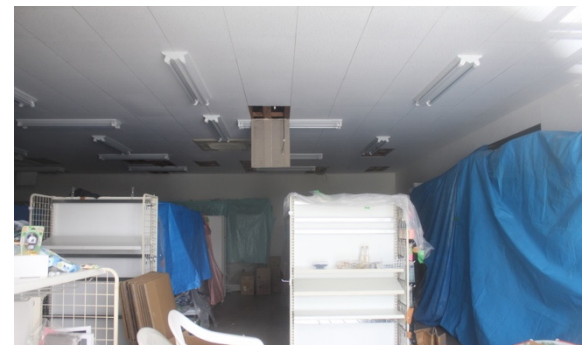
写真 5.1.26 屋根被害を受けた店舗 A の内部
