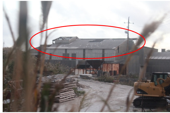
写真 5. 2. 42 工場の屋根と外壁の被害
