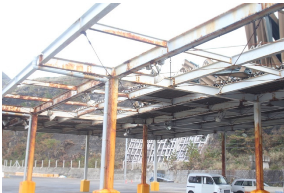
写真 5.2.32 漁港施設 A の屋根被害
