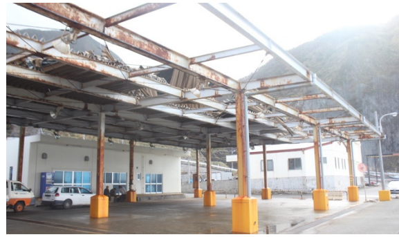
写真 5.2.31 漁港施設 A の屋根被害
