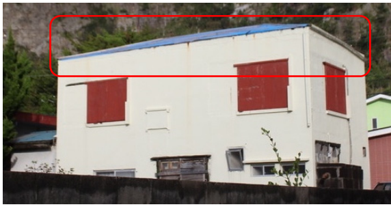
写真 5.2.36 住宅の屋根被害(3)
