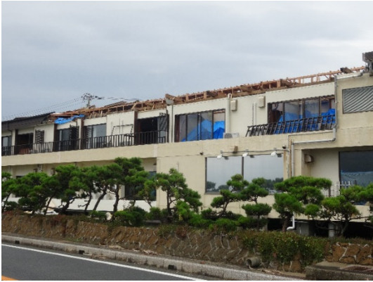
写真 4. 2. 19 木造部分の屋根とベランダの被害状況
