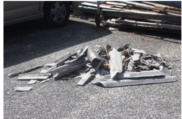
写真 5.2.5 脱落した屋根材
