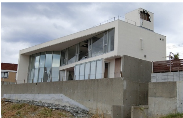
写真 4.3.71 海岸側の窓ガラスの破損
