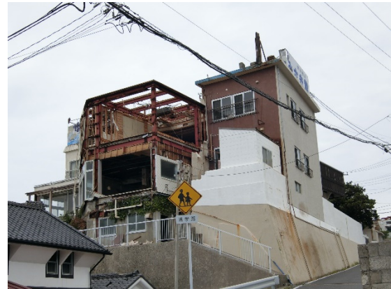
写真 4. 3. 40 宿泊施設 F の外壁の脱落状況
