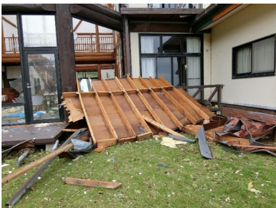
写真 4. 3. 52 脱落した屋根
