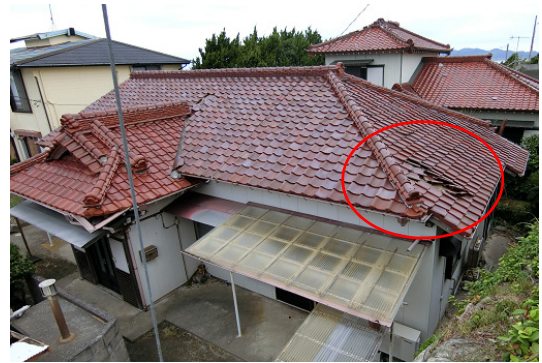
写真 4.3.32 平瓦の部分的なずれ又は破損
