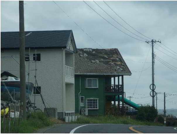
写真 4.2.25 屋根瓦の被害(風上側)
