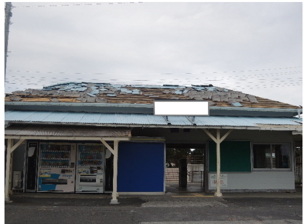
写真 4.1.8 駅舎での屋根瓦の被害
