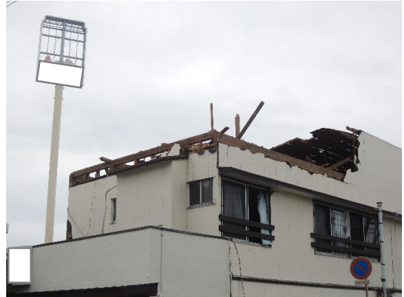
写真 4.2.10 店舗 G の小屋組の損壊(2)
