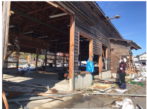
▲被害調査の様子
