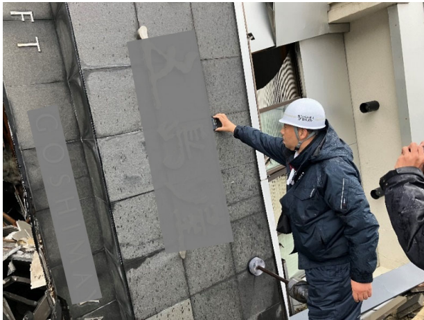
▲被害調査の様子
