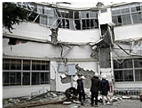
写真-2 地震による被害建築物（福島県）
