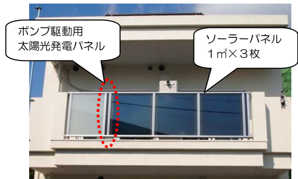
写真4 ソーラー給湯システム実用化製品設置例
