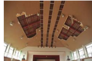
平成13年芸予地震時の天井脱落状況
