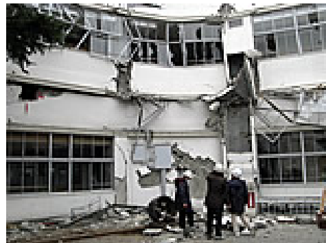
写真-1. 4. 1. 2 地震による被害建築物 (平成23年3月、福島)
