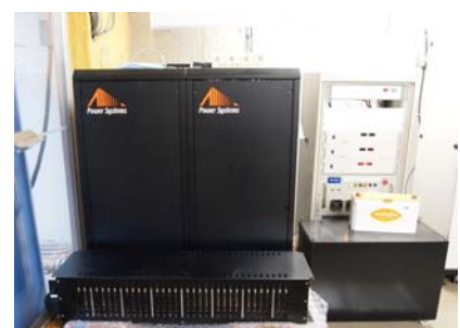
写真2 蓄電装置 左奥：キャパシタバンク (1.6kWh) 手前：リチウムイオン電池 (160AH)
