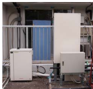
写真1 ガスエンジン発電ユニット
