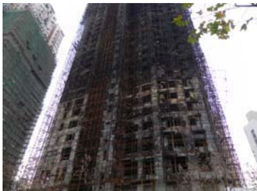
写真一1. 1. 2. 2 上海の高層マンション火災現場（平成 22 年 11 月発生）
