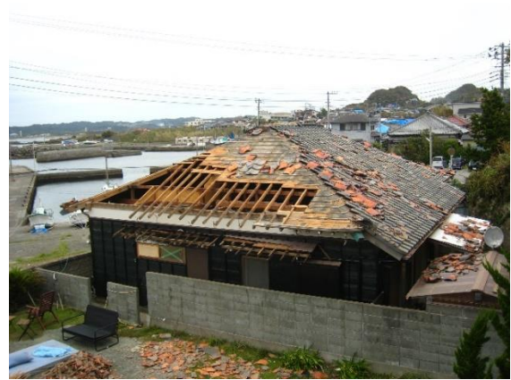
(b) 屋根ふき材や野地板が飛散した住宅
