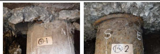
図 1.3 杭被害の事例 (左: 既製杭, 右: 鋼管杭)
