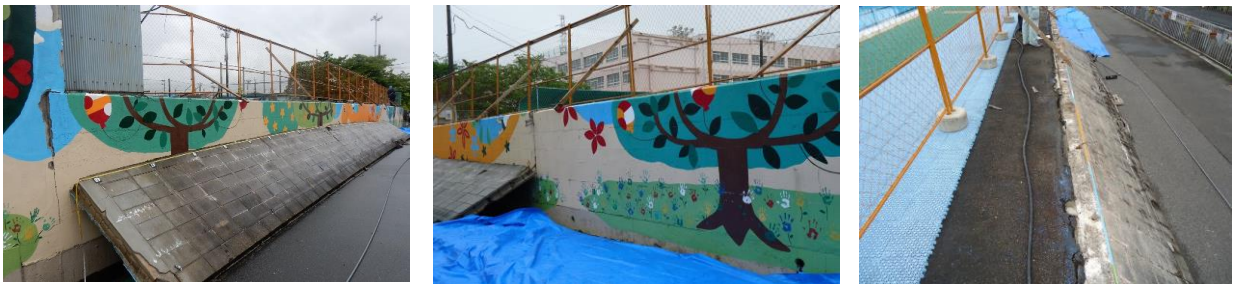
写真-I-1. 2. 3 倒壊した補強コンクリート造ブロック塀の状況
