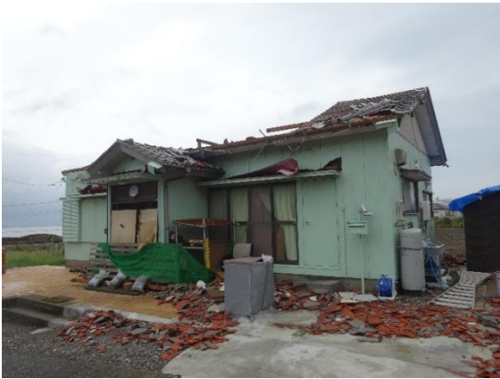
(a) 小屋組が飛散した住宅
