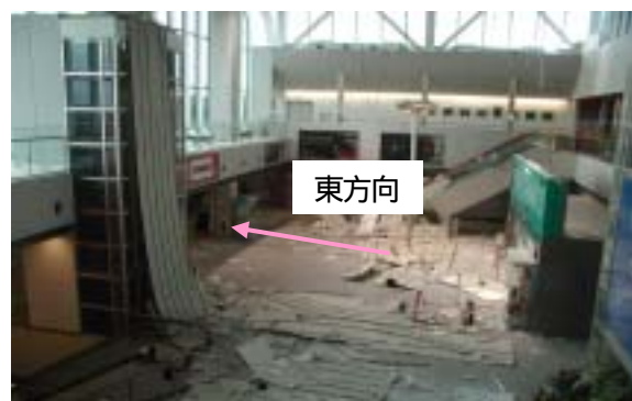
写真3 ターミナルビル内部の天井落下状況
