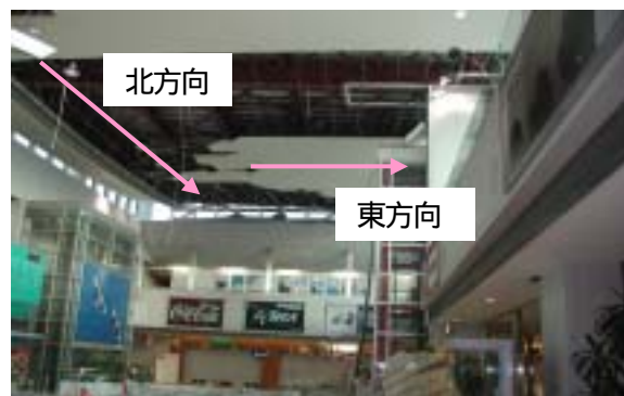
写真2 ターミナルビル内部の天井落下状況
