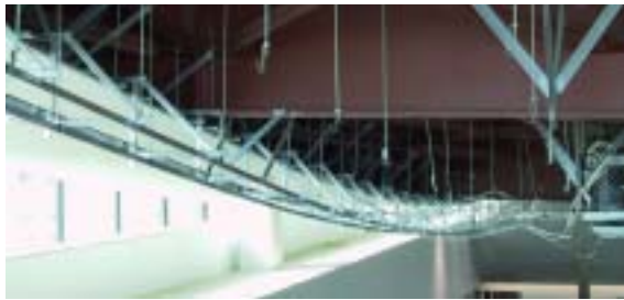
写真4 段差位置の状況（下に凸な弓形状が明瞭）
