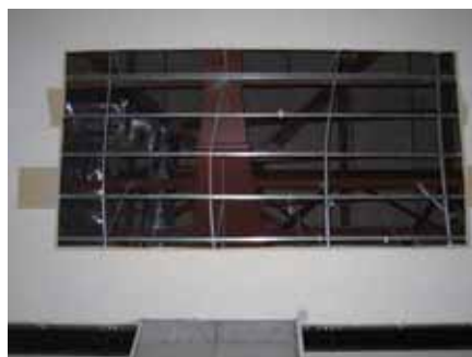
図3-2 天井端部における損傷
