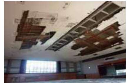
図5-2 天井面の中央部での損傷
