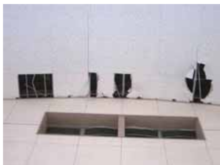
図3-1 天井端部における損傷
