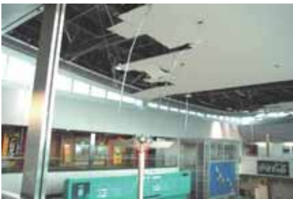
図4 段差部における損傷
