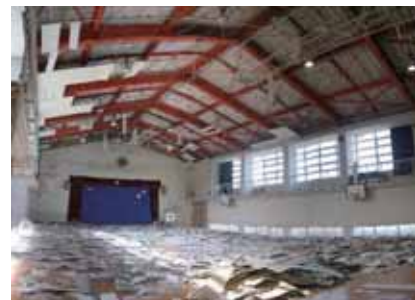
図6-2 全面的な天井脱落
