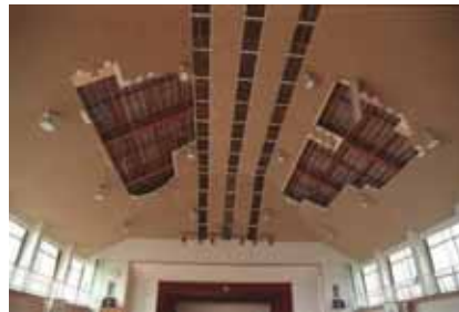
図5-1 天井面の中央部で損傷
