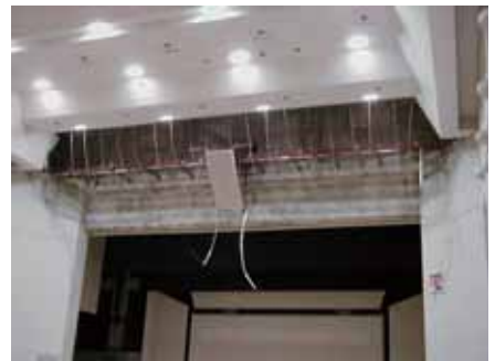
図3-3 天井端部における損傷
