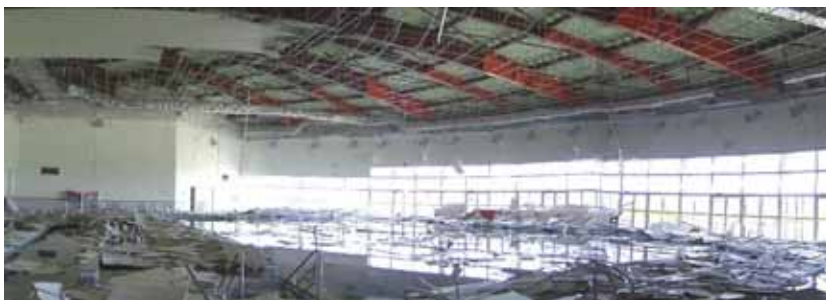
図6-1 全面的な天井脱落
