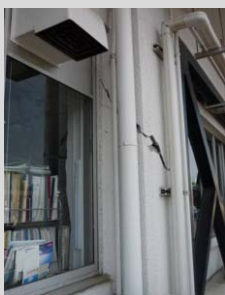
ブレースが取付く柱のせん断破壊(C-8)
