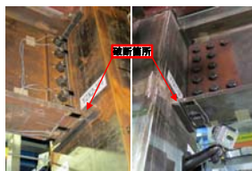
鉄骨造3層実大架構試験体の実験後の梁端部下フランジの破断状況
