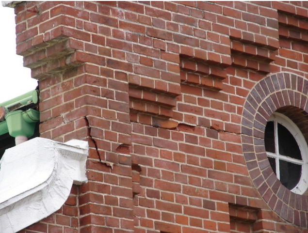
写真-5 重要文化財 シャトーカミヤ旧醸造施設（茨城県、煉瓦造、1903年）平成23年東北地方太平洋沖地震によりゲブル部分がおそらくロッキングして被災した
