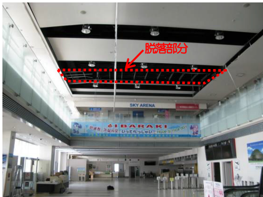
写真 1 空港での天井脱落被害
