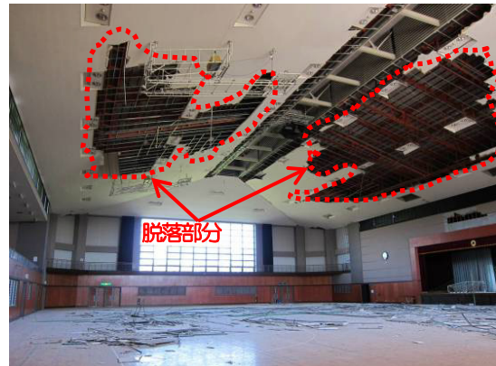
写真 2 体育館での天井脱落被害
