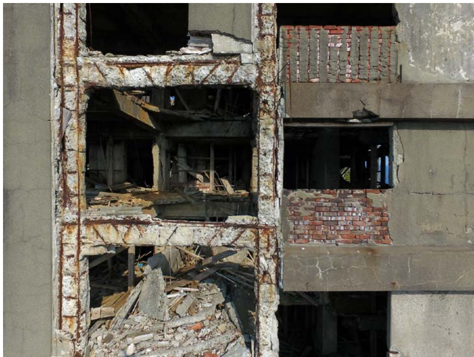
構造躯体欠損の状況
