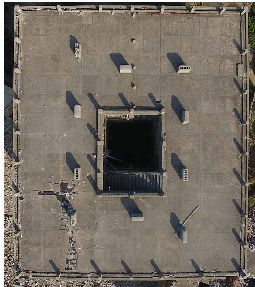
屋根面の損傷状況
