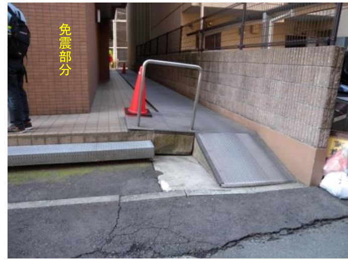
周囲地盤の沈下に伴う段差
