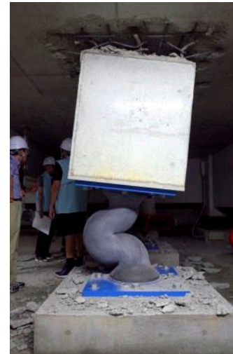
ダンパー取付け基部の損傷
