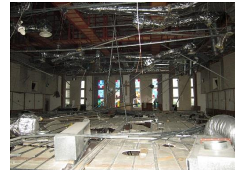
天井材の落下(講堂)
