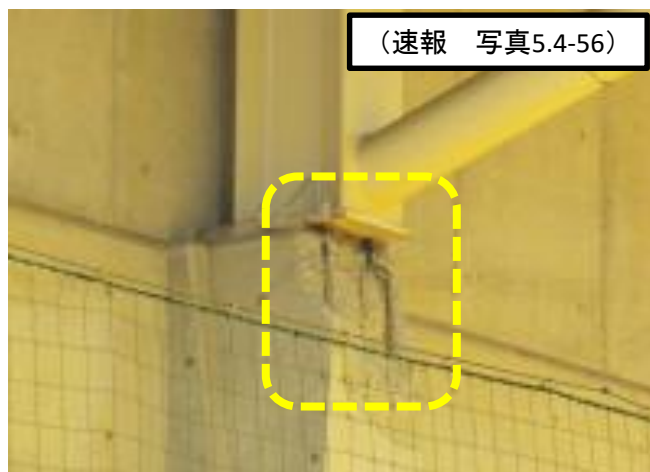
熊本市内(体育館) 鉄骨屋根支承部のコンクリ破損・脱落
