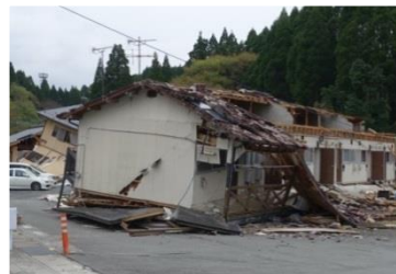
南阿蘇(共同住宅) 1階が崩壊
