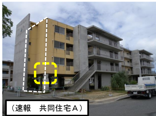
宇土市内(共同住宅) 1階柱頭の破壊
