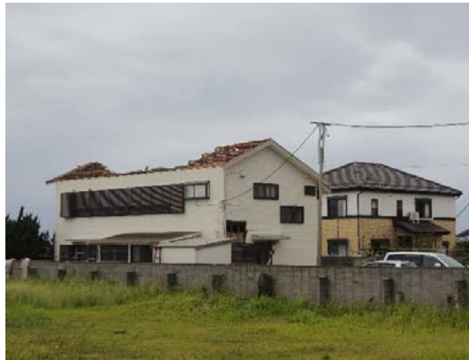
図14 木造住家の屋根の飛散(館山市) 海岸沿いに建つ木造2階建て住宅では、小屋組の大部分が損壊していた(図14)。小屋束が複数本残存しており、小屋束上部のほぞから横架材が抜けた状況が確認できる。一方、図14の被災した住宅の右の比較的新しいと思われる住宅では、屋根の被害は極めて軽微である。
