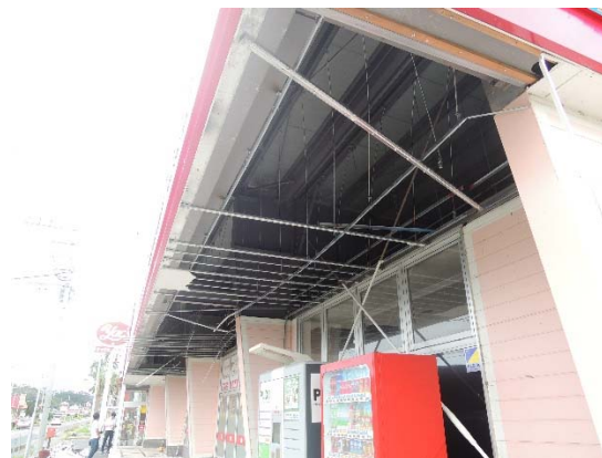
図40 鉄骨造平屋建ての店舗の軒天井の被害(鋸南町)
