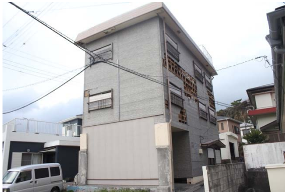
図30 住宅の壁被害(神津島村)
