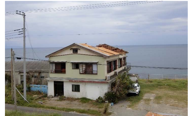
図15 木造住家の屋根の飛散(館山市) 図15に示す海岸沿いの木造住宅は総2階建てであり、屋根の大部分が飛散し、一部の小屋組も損傷していた。この住宅については、最近空き家になっていたとの情報が寄せられた。
