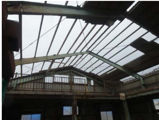
図13 鉄骨造施設の屋根の飛散 (南房総市)
