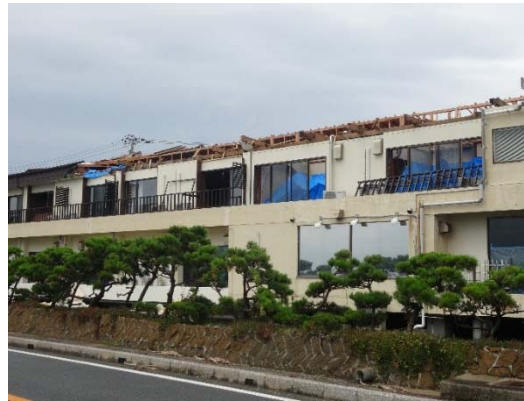
図11 小屋組が飛散した木造宿泊施設(南房総市)
