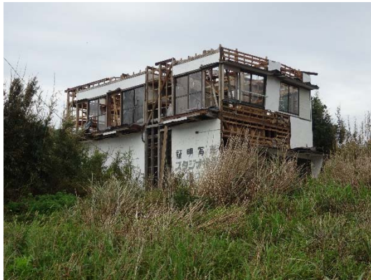
図16 木造住宅の屋根の飛散と外壁の被害(南房総市)
