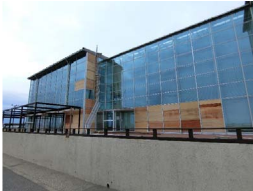
図33 店舗建築物の破損した窓ガラス
