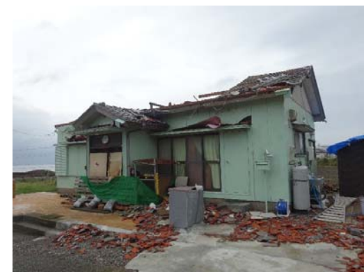
図12 小屋組が飛散した住家(南房総市)
