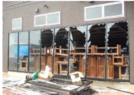
図31 屋外に面する建具の損壊(南房総市)
