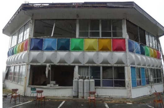
図34 公園施設のサッシ・窓ガラスの被害
