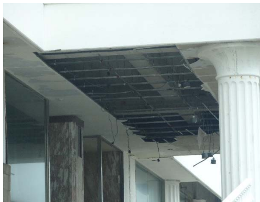
図39 宿泊施設のエントランス部の軒天井の被害(南房総市)
