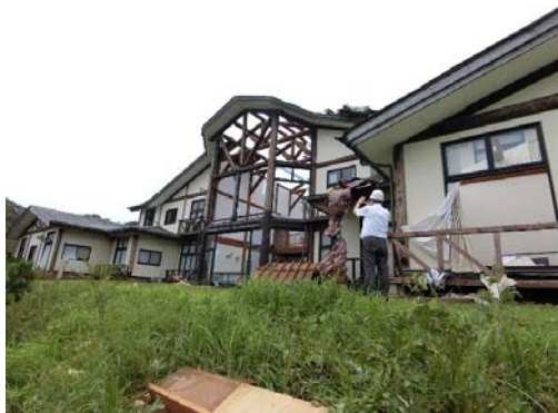
図36 宿泊施設の窓ガラスの破損と屋根の崩落(館山市)
