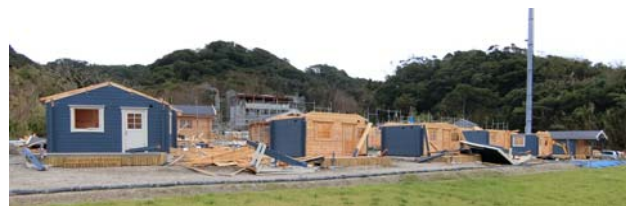
図20 建築途中の12棟のログハウスの被害状況(館山市)
