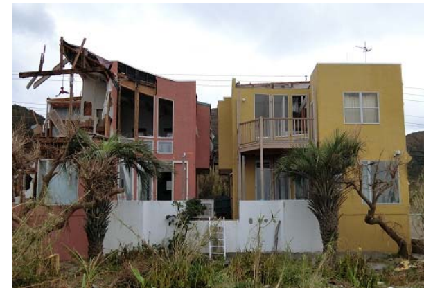
図9 海岸沿いに建つ2棟の木造住宅(館山市)
