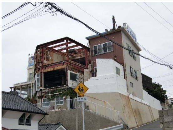
図27 宿泊施設の外壁の脱落状況(館山市)
