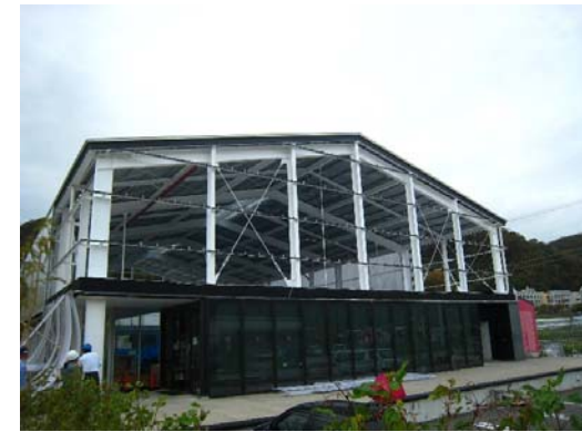
図35 妻面の全外壁材が脱落した店舗(鋸南町)
