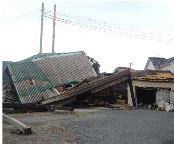
図5 鉄骨造倉庫の倒壊(鋸南町)
