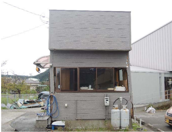
図7 小規模木造圓地区物の残留変形(鋸南町)
