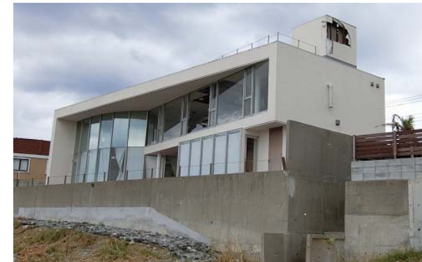
図32 鉄骨造建築物の窓ガラスの破損(館山市)
