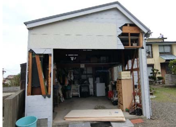
図8 外壁材が脱落した車庫(館山市) 車庫の外壁材が脱落していた(図8)。車庫が南(図8の左側)からの風圧力を受け、耐力壁がせん断変形して筋かいが座屈したとみられる。さらに、掃き出し開口右上部分の外壁材の脱落は、門形のフレームが右側にせん断変形したときに外壁材が座屈破壊したのではないかと想像される。
