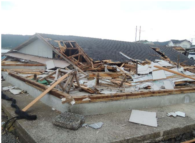
図4 木造倉庫の倒壊(鋸南町)
