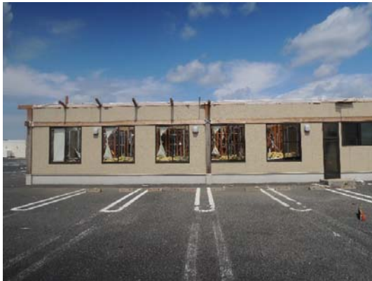
図10 小屋組が飛散した店舗(南房総市)
