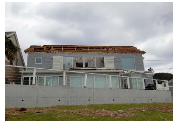
図18 木造住家の屋根の飛散(館山市)
