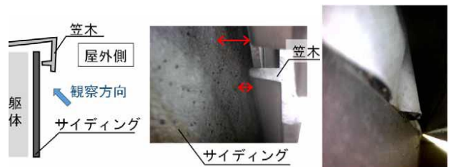
図 30 サイディングと笠木の隙間 写真 5 防水紙のめくれ
