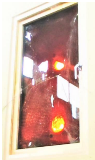
熱応力による破損
