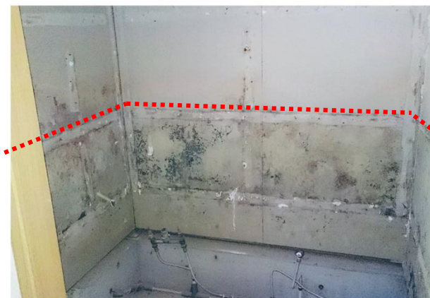
UB撤去後のカビ被害
