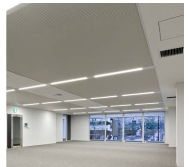
2階：輻射天井空調システム
