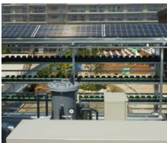
太陽光パネル 15kw (緑化目隠し上部・他)
