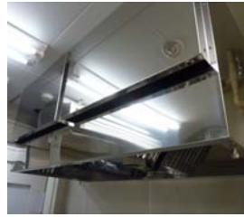
・厨房給排気二重フード
