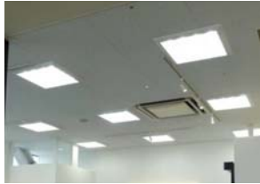
・全館LED照明
