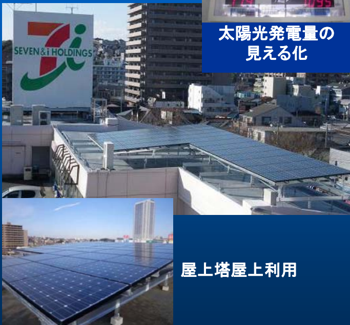
太陽光発電設備
