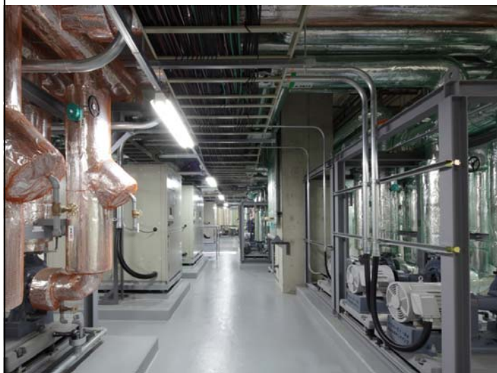
井水熱回収HPチラー（冷暖房&給湯）
