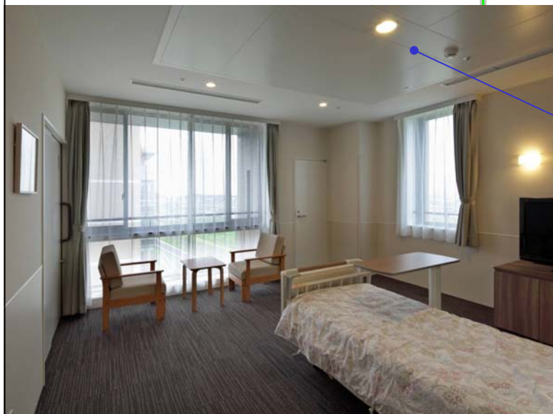
天井放射冷暖房システム (冷温水パネル+水熱源PACエアコン)
