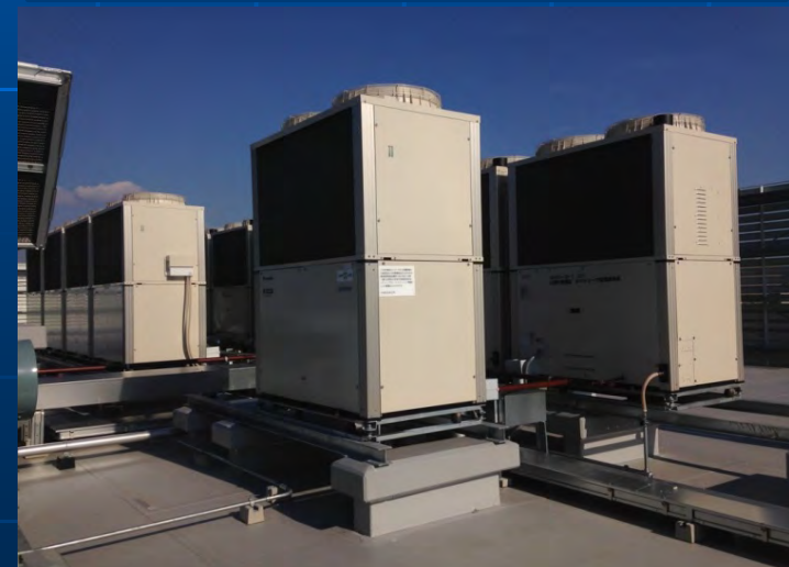
ガスヒートポンプエアコン (広島大学東千田キャンパス設置)
