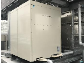
水蓄熱ビル用マルチ空間
