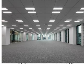
人検知センサー照明制御
