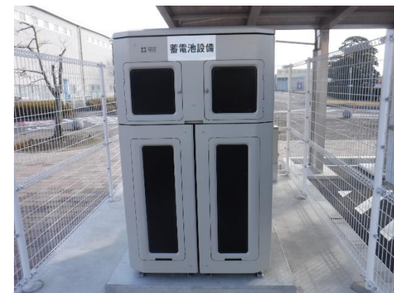
リユース蓄電池
