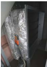
自然換気ダンパー
