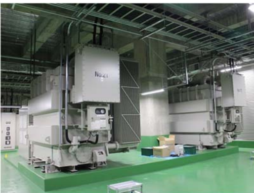
特高変圧器(7,500kVA × 2台)
