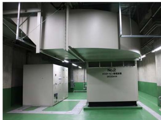
非常用発電機(3,000kVA × 2台)
