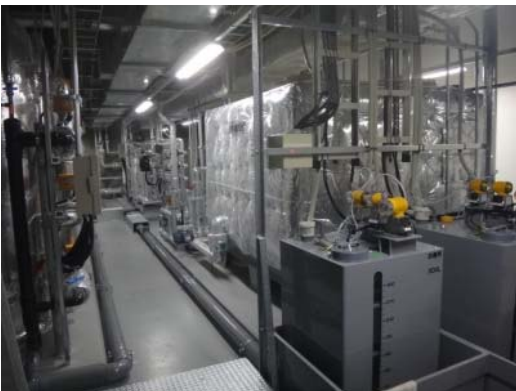
井水利用設備
