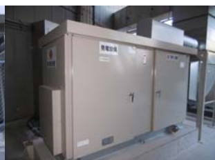
防災用発電機
