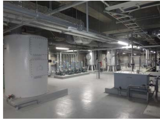
厨房排水利用設備
