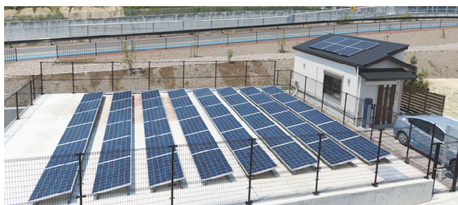
公共施設用地に設置した共用の太陽光発電
