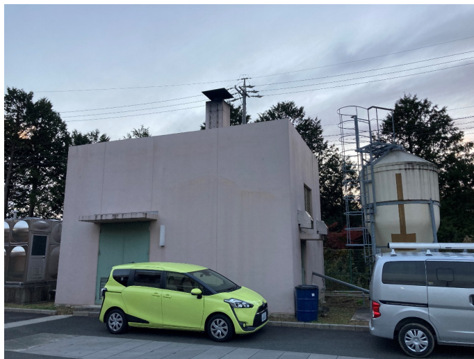
2.ペレットボイラ建屋と サイロの設置事例
