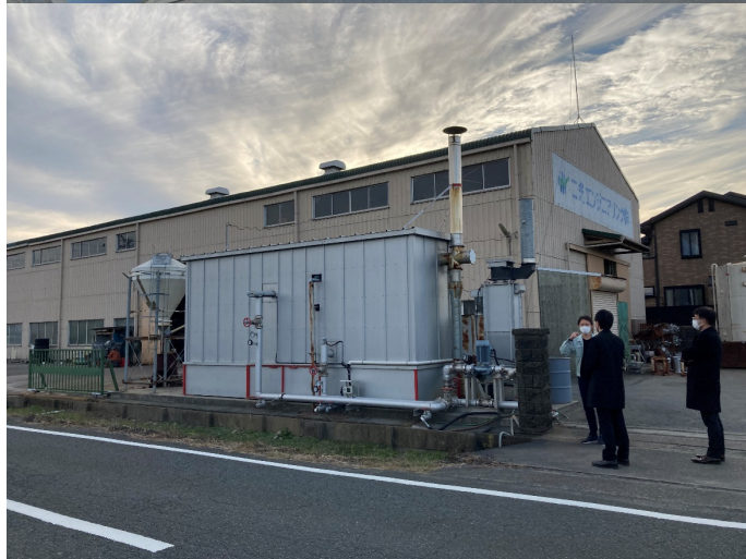
1.製造工場敷地内の ペレットボイラ本体と建屋
