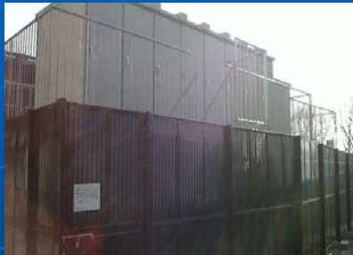
設置した一括受電設備
